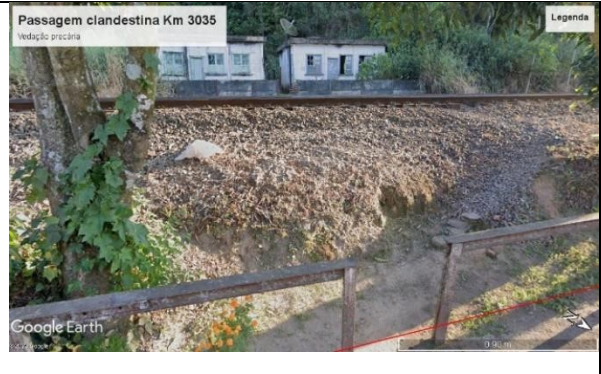
Figura 24: Passagem clandestina e vedação precária no km 303
