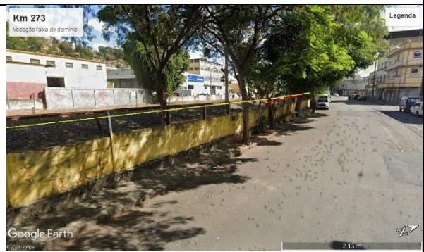
Figura 30: Vedação precária no km 273
