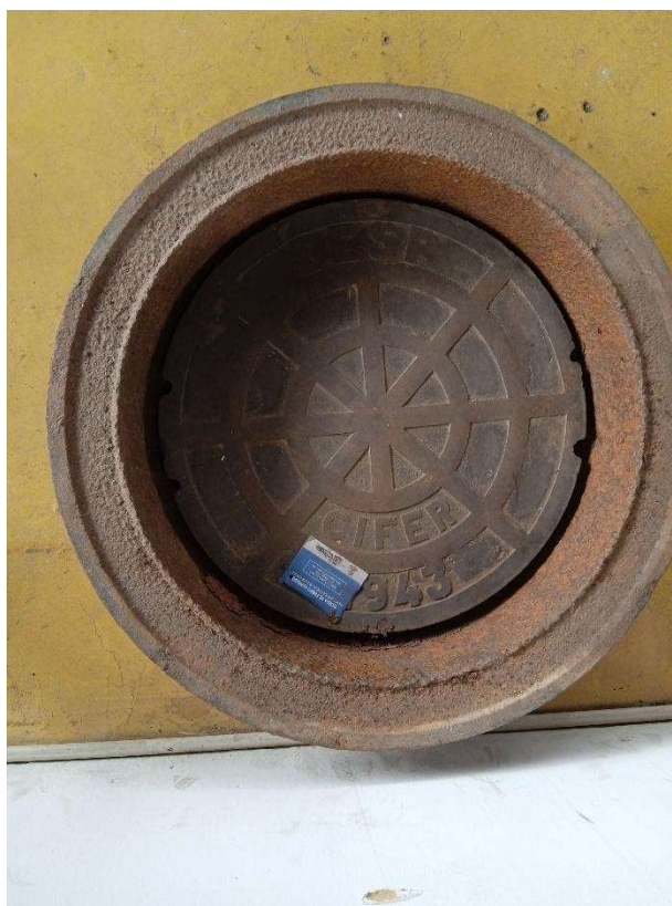
Figura 22 – Tampa de bueiro do SESP
