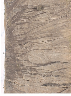
Sulcos na rocha causados pela água das chuvas.
