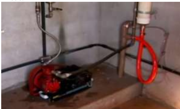
Foto 8 – Compressor para condução do biogás à rede.
