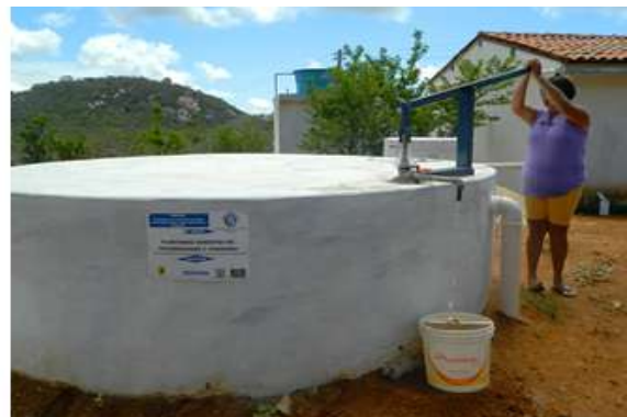
Foto 24 – Bomba d'água Trampolim
