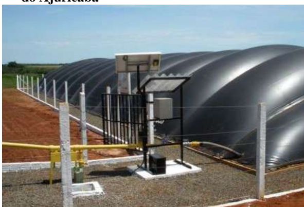
Foto 10 – Microcentral Termelétrica a Biogás do Ajuricaba
