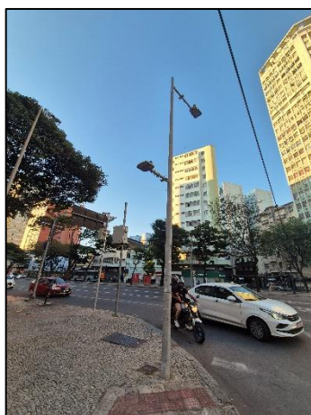
Figura 13 – Poste metálico H=9,5m
