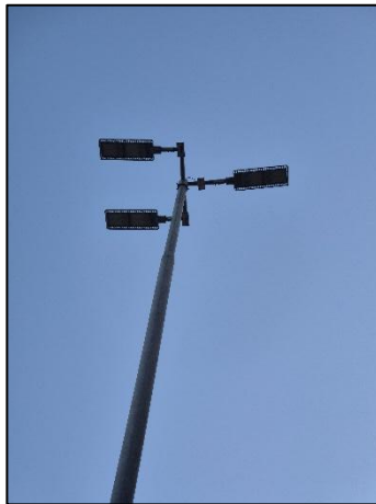
Figura 15 – Luminárias Praça Sete
