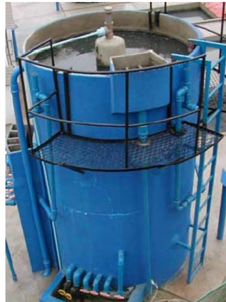
Figura 4.2 – Vista do reator UASB R3 existente na ETE experimental
