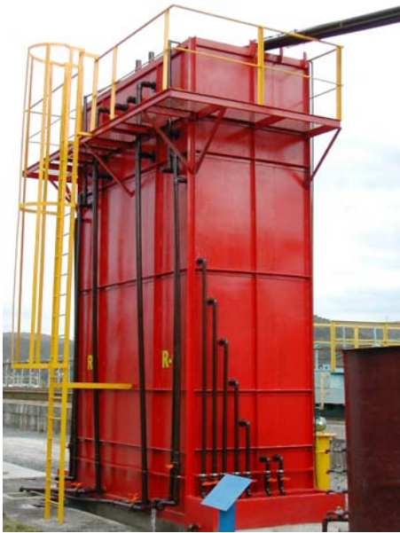
Figura 4.1 – Vista dos reatores UASB R1 e R2 antes da fase 1
