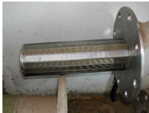
Figura 4.3 – Vista da peneira componente da unidade de peneiramento
