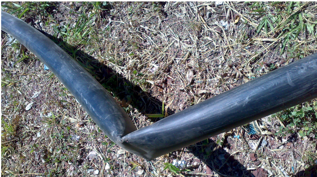
Figura 3.39: Tubo de PEAD dobrado devido a manuseio incorreto.
