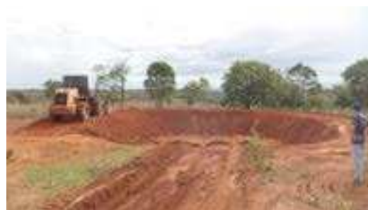
Figura 5 - Bacia de contenção em Curvelo
