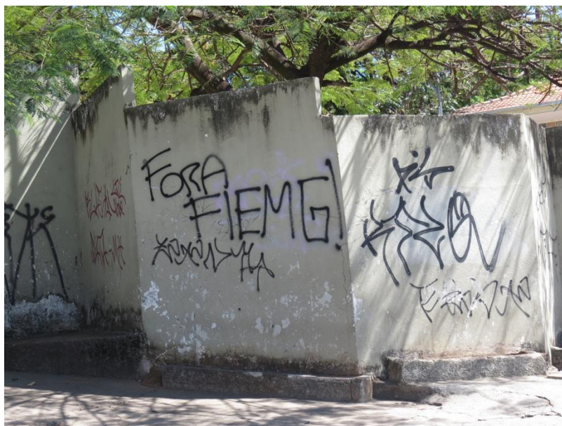
FIGURA 22 – Muro do Mercado Distrital Santa Tereza, 5 de setembro de 2014.
