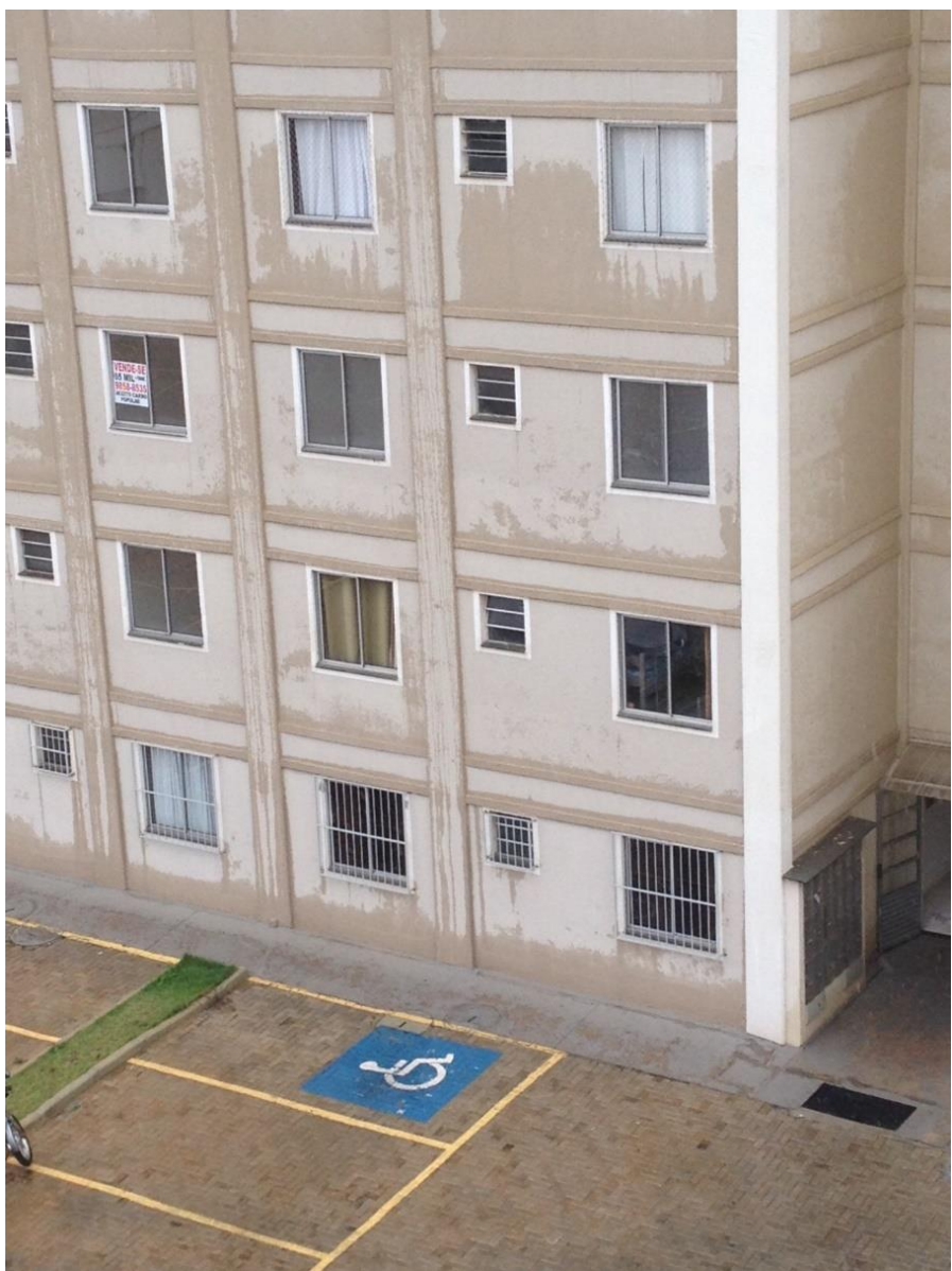
Figura 11: Vista panorâmica do bloco com pontos de acúmulo de água. Fonte: Arquivo Pessoal
