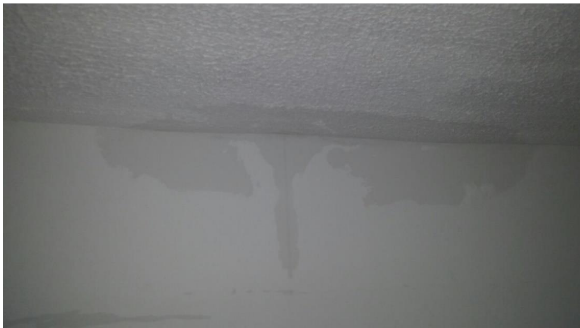
Figura 8: Registro interno do apartamento do cliente com infiltração. Fonte: Arquivo Pessoal
