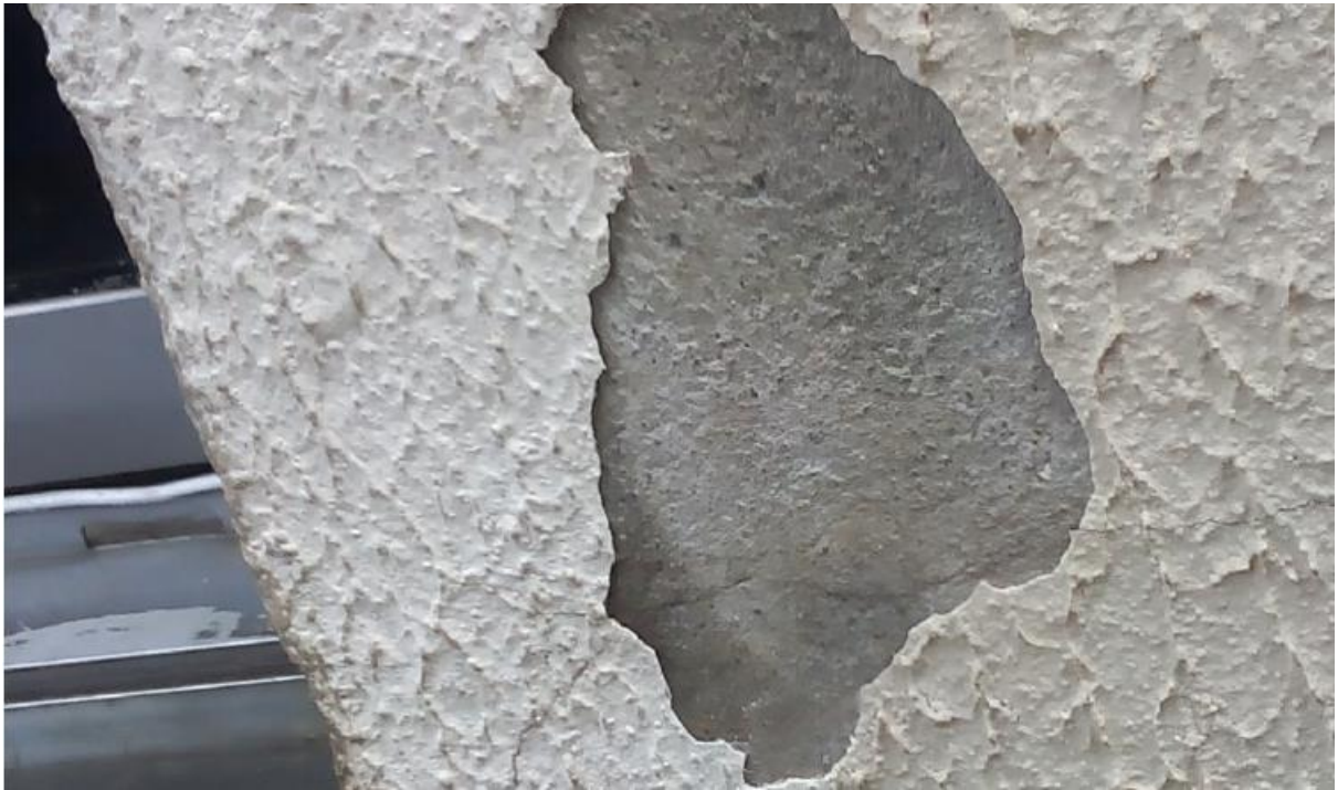
Figura 13: Descolamento de textura. Fonte: Arquivo Pessoal
