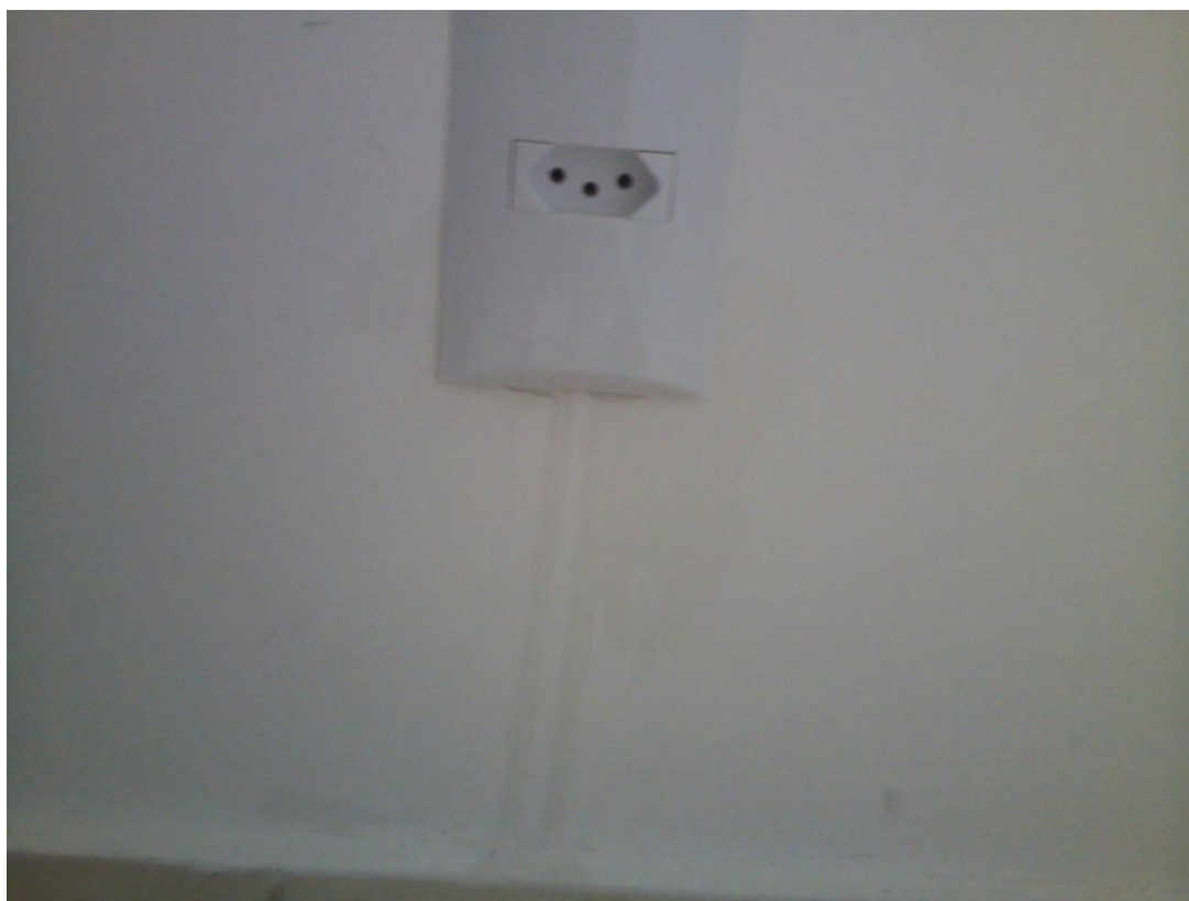
Figura 9: Registro interno do apartamento do cliente com infiltração. Fonte: Arquivo Pessoal
