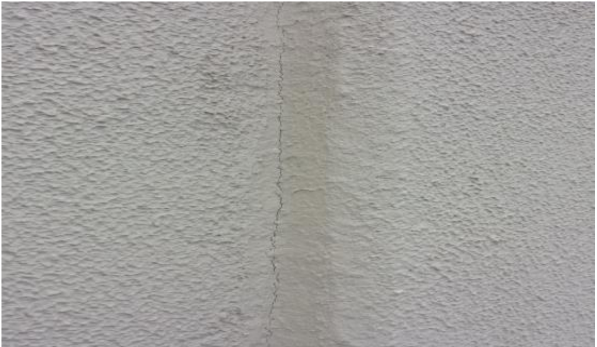
Figura 14: Trincas na textura. Fonte: Arquivo Pessoal
