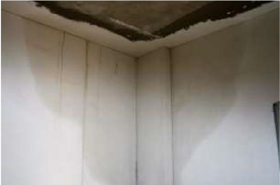
Figura 9: Ponto de infiltração – visto internamente. Fonte: Arquivo Pessoal
