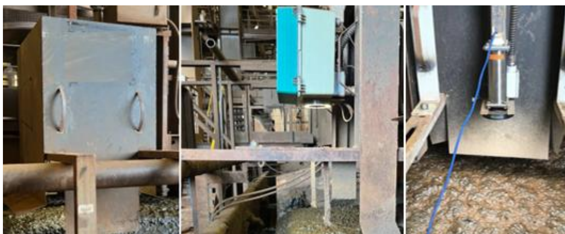
Figura 4.43 - Proteção e painel de câmera instalada sobre célula de flotação. Fonte: Autor.
