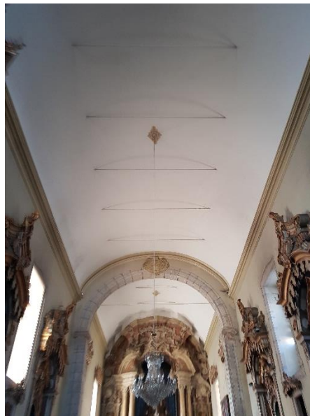
Figura 36: Tirantes metálicos fixados nas alvenarias da Igreja da Misericórdia em Guimarães, Portugal. Fonte: Autora, 2019.
