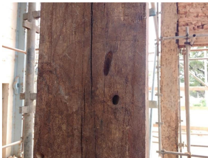
Figura 29: Degradação biótica causada por insetos xilófagos em um dos pilares na Igreja do Santíssimo Sacramento em Jequitibá, Minas Gerais.
