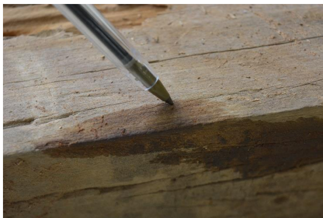
Figura 55: Concentração de umidade na região 2 no caibro 1. Fonte: Autora, 2017.
