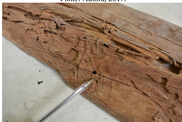
Figura 56: Ataque dos insetos xilófagos no caibro 1. Fonte: Autora, 2017.
