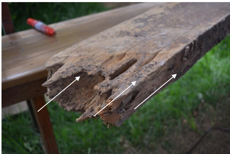
Figura 27: Degradação por fungos de podridão marrom na extremidade da cambota da cobertura da Igreja do Santíssimo Sacramento. Jequitibá, Minas Gerais.
