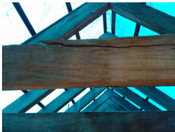
Figura 33: Fendilhamento da linha alta em uma tesoura de caibro-armado da Igreja do Santíssimo Sacramento.
