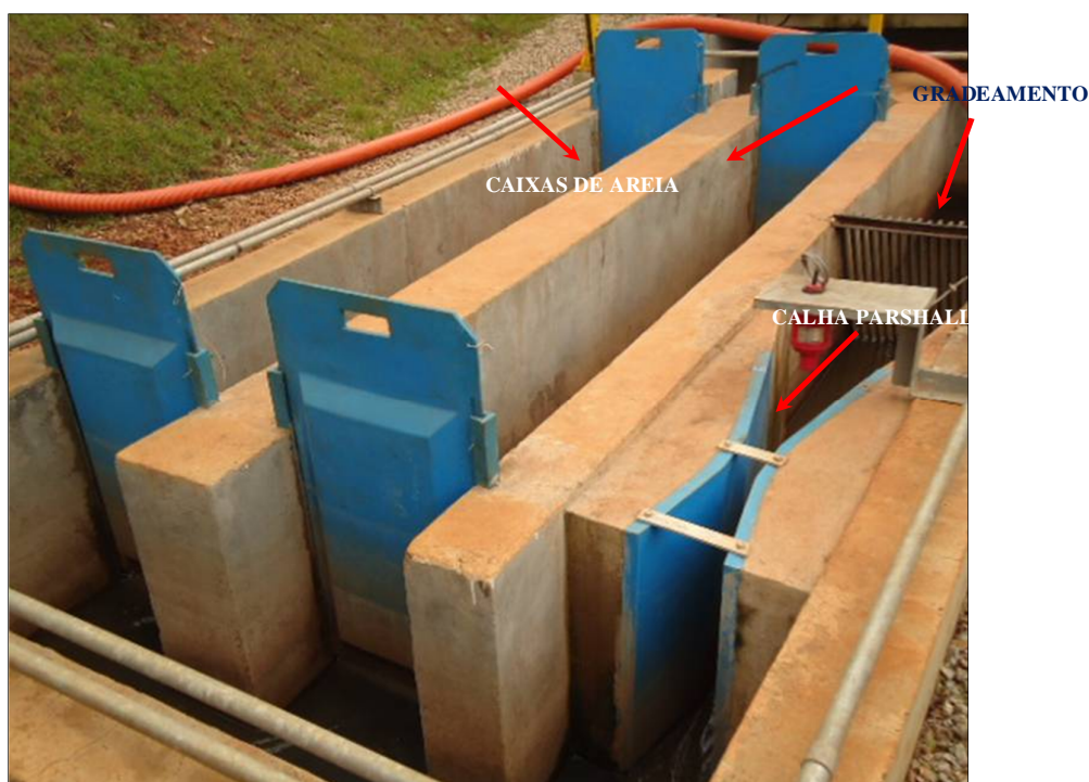
FIGURA 4.5 – Tratamento Preliminar – Gradeamento, Calha Parshall e Caixas de Areia
