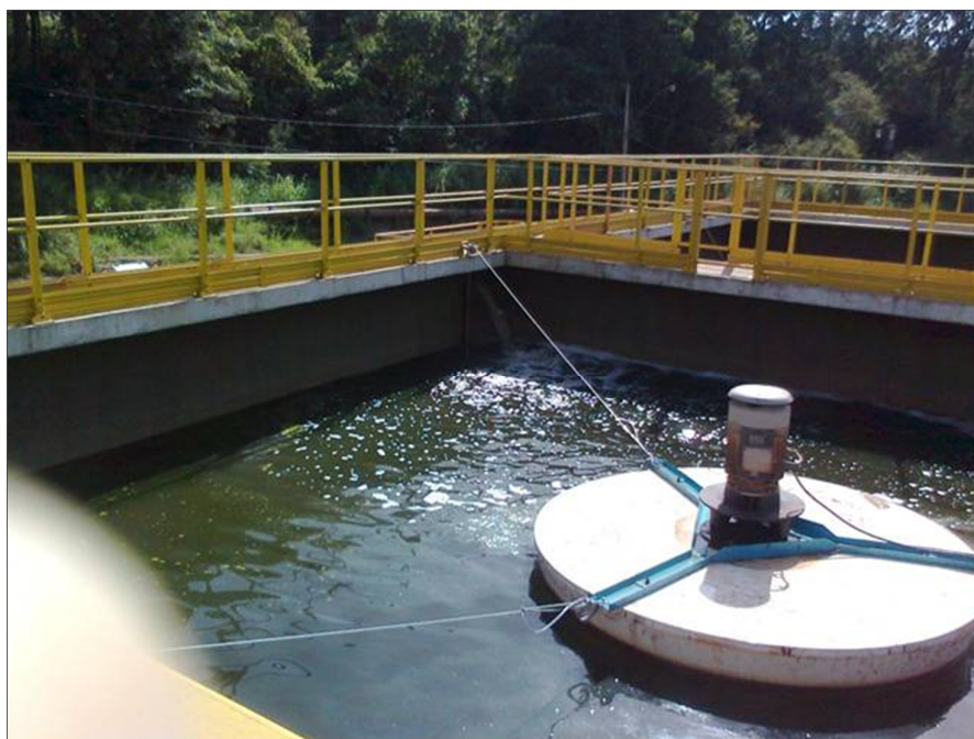
FIGURA 4.8 – Tanque de Aeração em repouso
