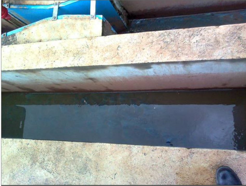
FIGURA 4.6 – Tratamento Preliminar – Caixa de Areia
