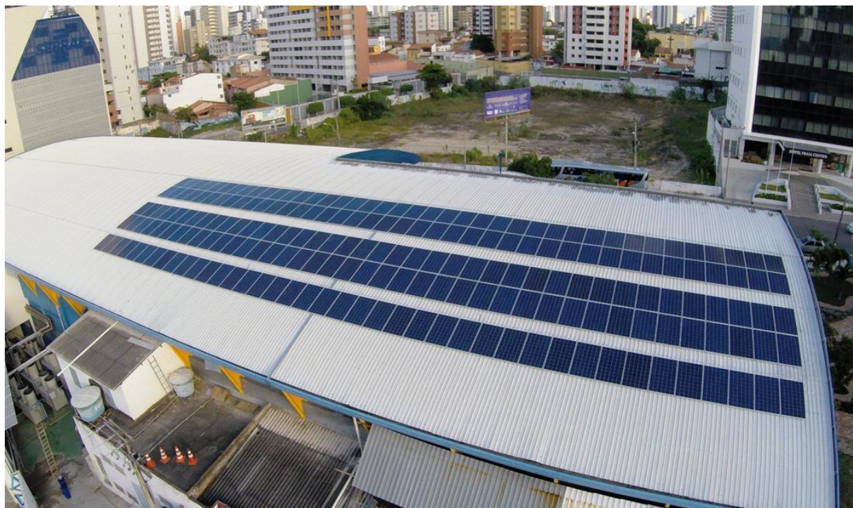
Figura 1 - Usina fotovoltaica SEBRAE em Fortaleza/CE [PEN 24]
