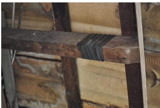
FIGURA 37 - Local onde foi realizado o ensaio de emissividade.
