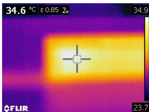
FIGURA 21 - Termograma da área coberta com fita isolante.
