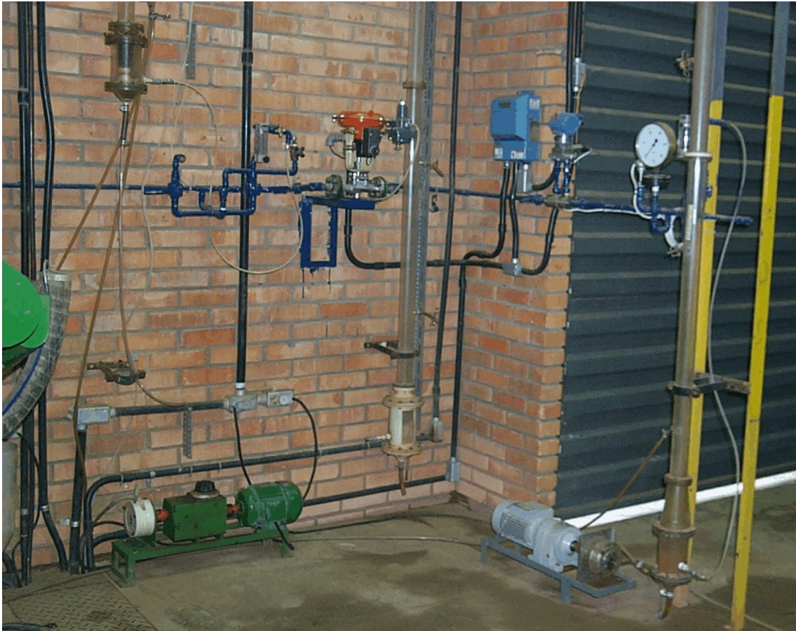
Figura 2.6: Vista da instrumentação da coluna de flotação de 2" do CDTN. São mostrados os circuitos de alimentação de ar e descarga de não flotado.
