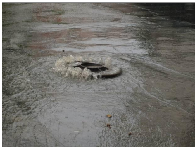
Figura 6: Drenagem não suporta a quantidade de água de chuva – bairro Anchieta, BH.
