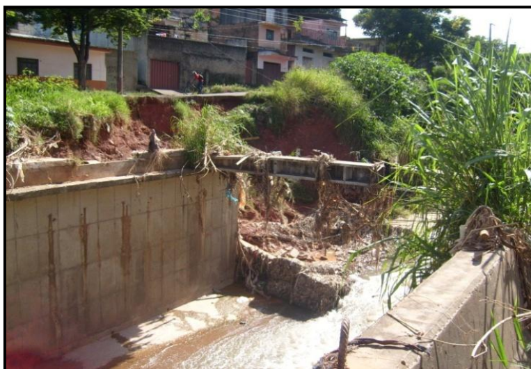
Figura 17: Rompimento do muro de gabião após chuva de 31 de dezembro de 2008. Avenida Tereza Cristina.
