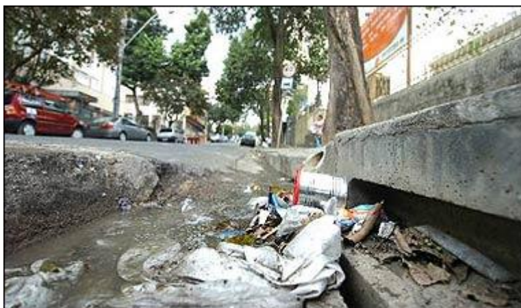
Figura 7: Lixo entupindo bueiro, Belo Horizonte. Fonte: Jornal Alterosa, 2009.
