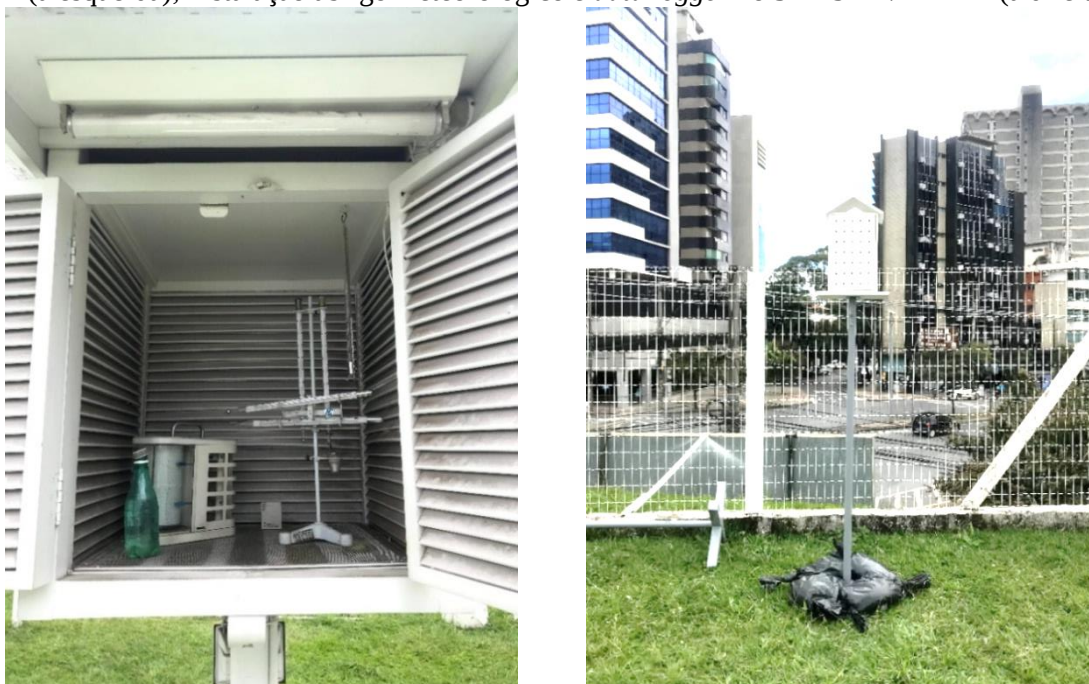
Figura 15 - Instalação aparelho termo-higrômetro no abrigo meteorológico padrão 5ºDISME/INMET (à esquerda); Instalação abrigo meteorológico e data logger no 5ºDISME/INMET (à direita)
