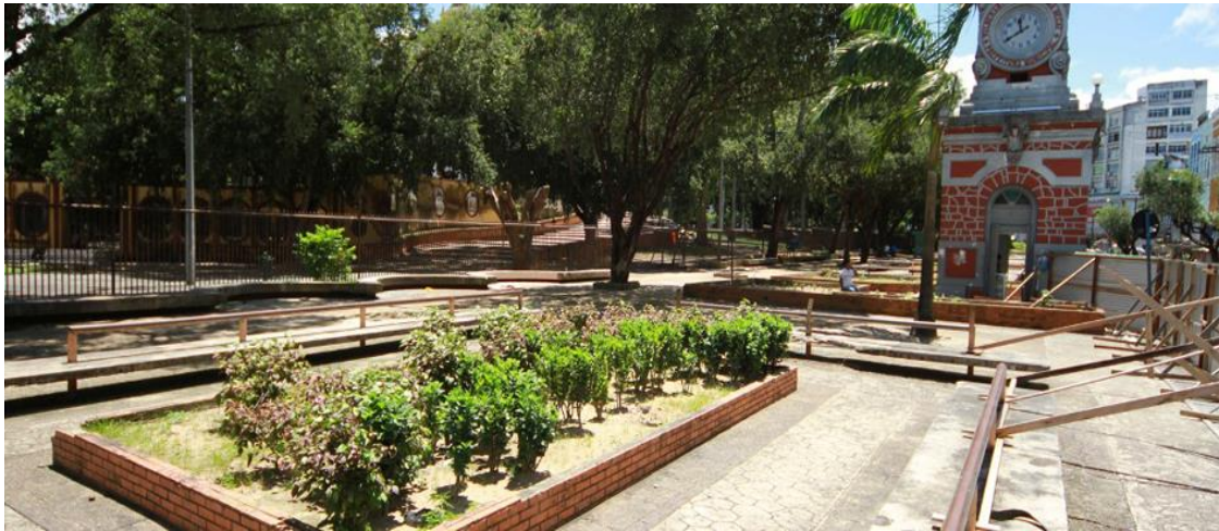
Reordenamento da Praça da Matriz. Restauração do calçamento original e da Jardinagem.
