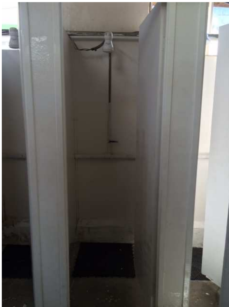
Figura 11 – Foto do chuveiro das instalações sanitárias.
