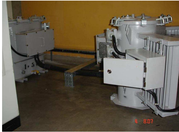
Figura 3.2: Transformador de Potência Utilizado na Bancada Regenerativa
