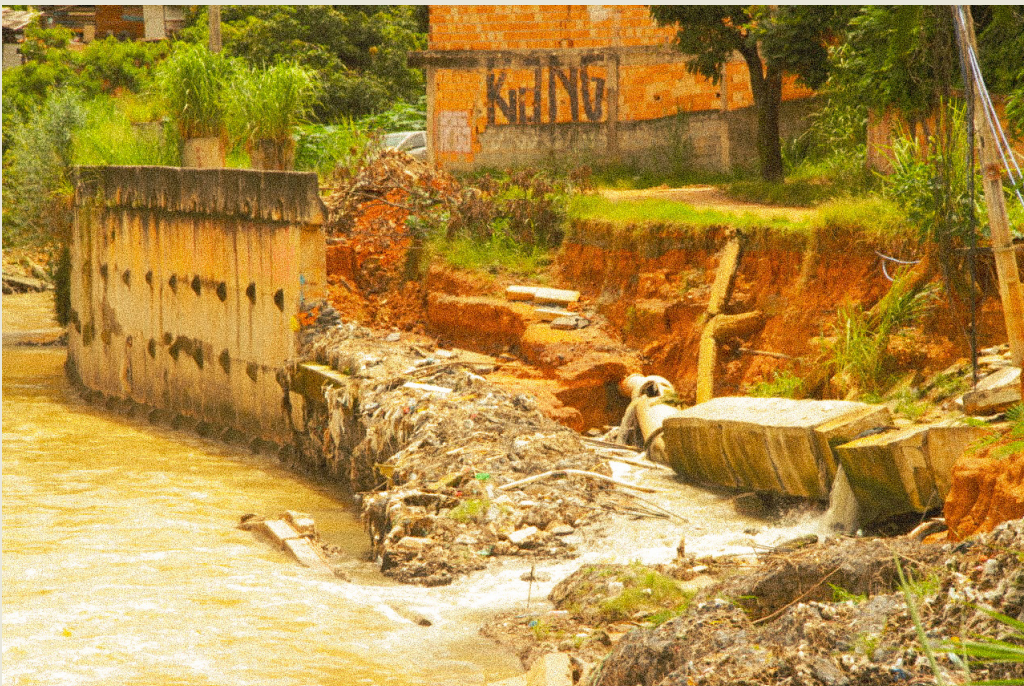
Figura 11. Intervenções degradadas no Ribeirão Onça, s/ data.
