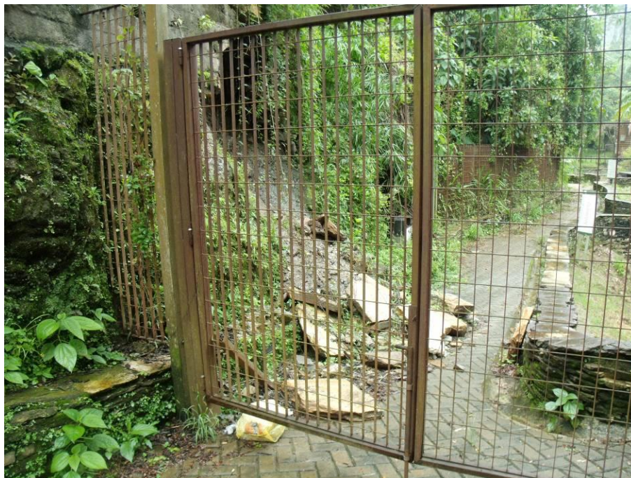
Figura 26 Deslizamento de encosta junto à portaria do Pilar
