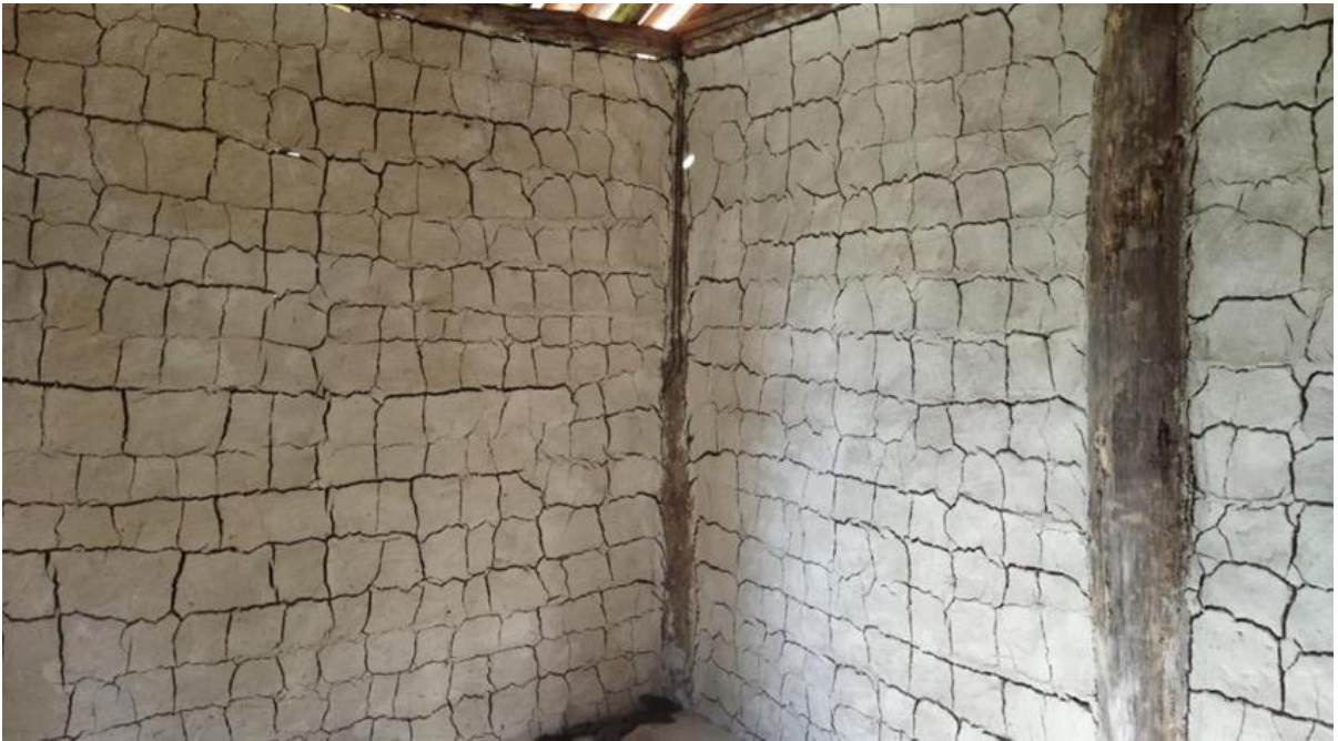
(Fonte: Naktã Pataxó, 2023, paredes do interior da casa)
