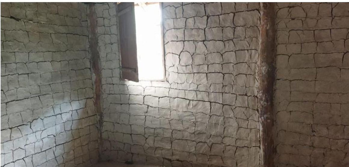
(Fonte: Naktã Pataxó, 2023, paredes do interior da casa)
