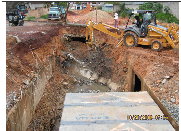
Figura 43 – Rede tubular de concreto DN 1.000, interferente com a galeria em execução.
