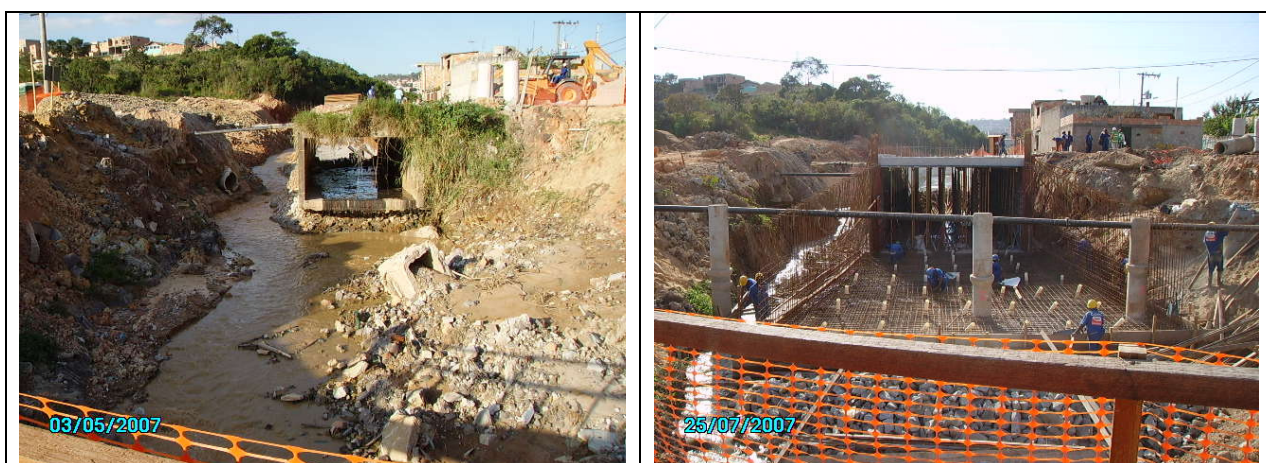
Figura 38 – Estaca E95+7.0 – Caso 01. Vista das adutoras remanejadas e da galeria a ser demolida.
