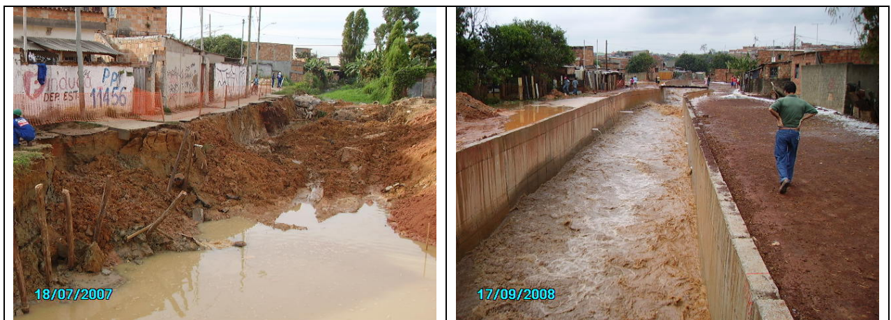
Figura 26 – Vizinhança ao redor do leito do córrego. À esquerda, desbarrancamentos inviabilizaram o prosseguimento da obra. À direita, a galeria fez uma “curva” para sair fora de benfeitoria.
