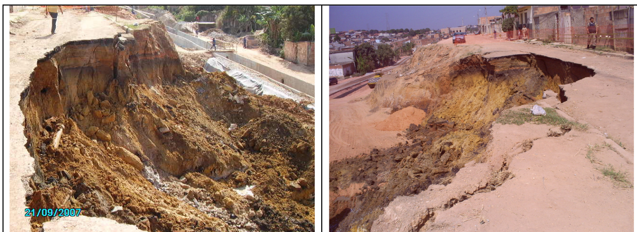
Figura 28 – Deslizamento de encostas. Detalhe para o tubo cerâmico da rede de esgoto existente, com vazamento, e a extensão do estrago provocado pelo mesmo.
