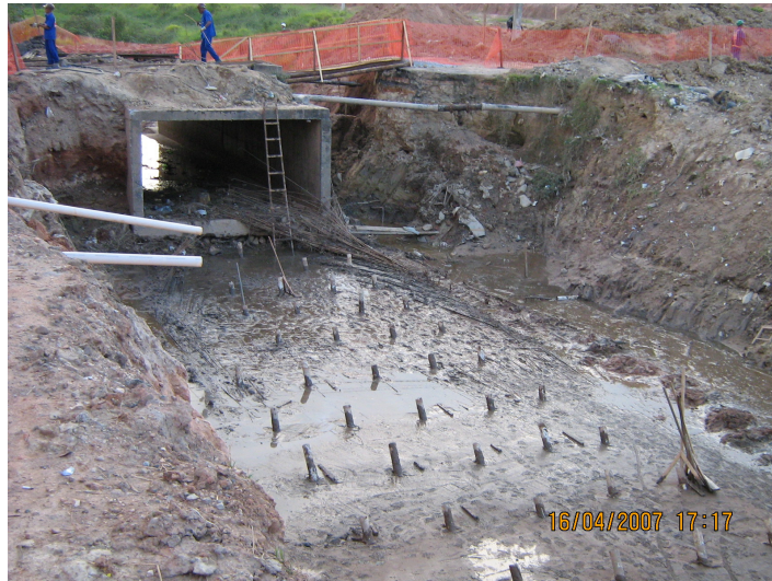
Figura 10 – Aspecto da obra após a inundação.
