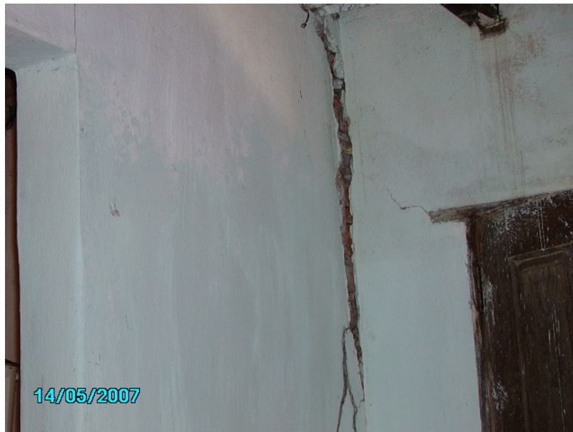
Figura 2 – Trincas decorrentes de movimentação do terreno em benfeitoria localizada fora do trecho da obra.
