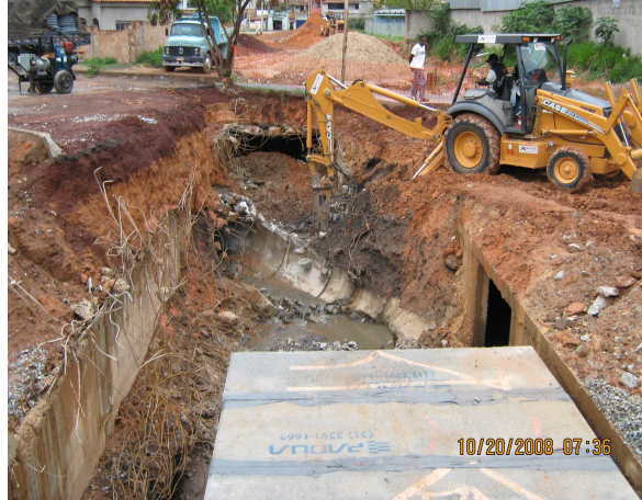
Figura 3 – Interferências: ao centro, rede de água pluvial, DN 1000, com esgoto clandestino. À esquerda e ao fundo, detalhes da demolição de uma galeria de concreto moldado interferente com a galeria pré-moldada em execução. À direita, galeria existente aproveitada
