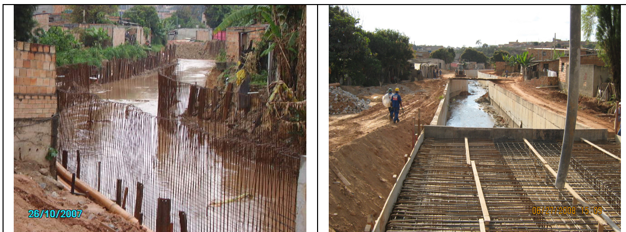
Figura 20 – Caso 01. Vizinhança ao redor do leito do córrego. Vista de parte das benfeitorias assentadas em áreas invadidas e do desvio, à direita, que teve que ser feito no alinhamento da galeria para “sair fora” de benfeitoria ainda não indenizada.
