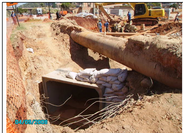
Figura 40 – Adutora de água tratada DN 1.000 mm.
