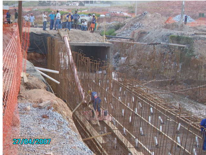
Figura 4: Execução de laje de fundo. Vista do posicionamento dos drenos de alívio.
