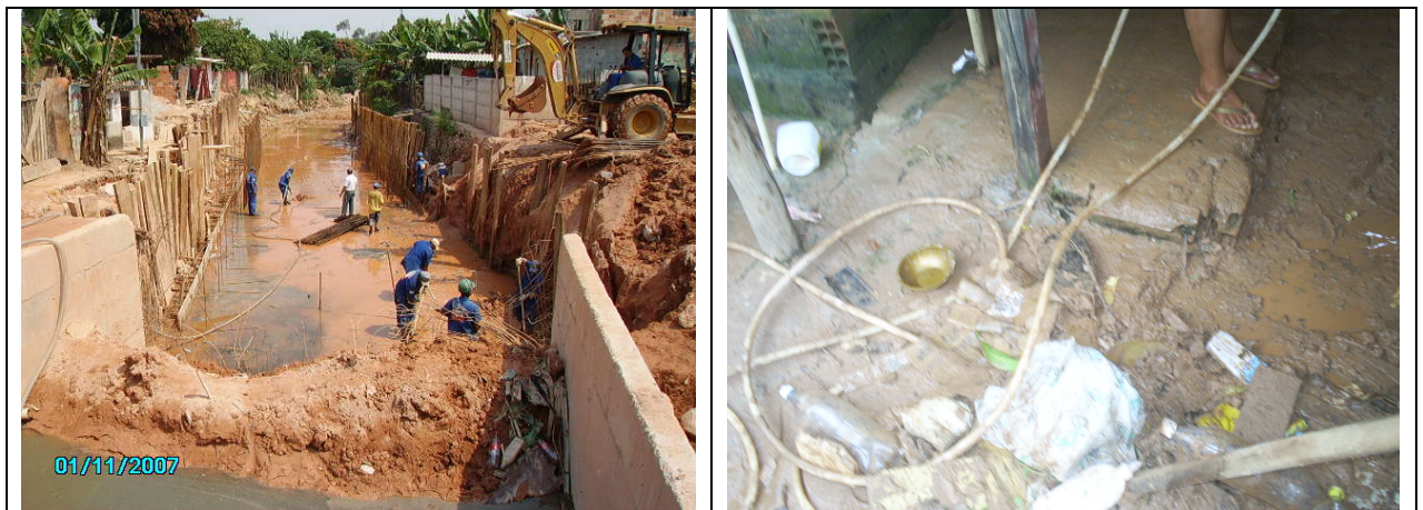
Figura 13 – Vista da vizinhança ao redor da obra inundada.
