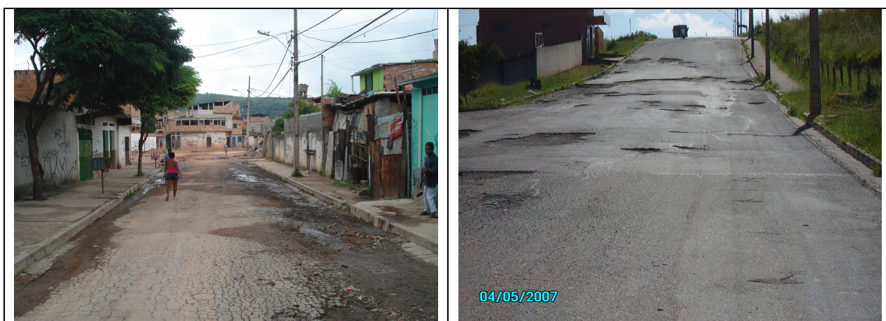
Figura 27 – Caso 01: Vias públicas do Bairro, danificadas pelo tráfego de caminhões pesados, ao transportar material para bota-fora e para aterro mecanizado.
