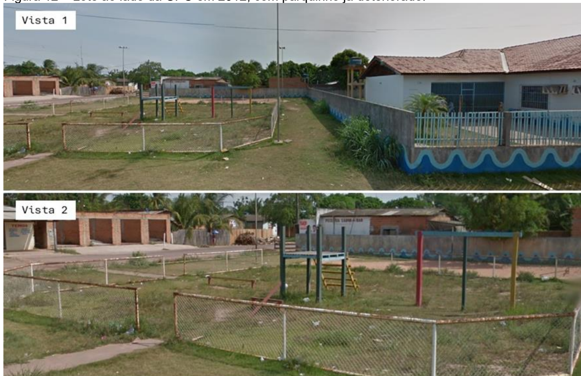
Figura 12 – Lote ao lado da UPC em 2012, com parquinho já deteriorado.
