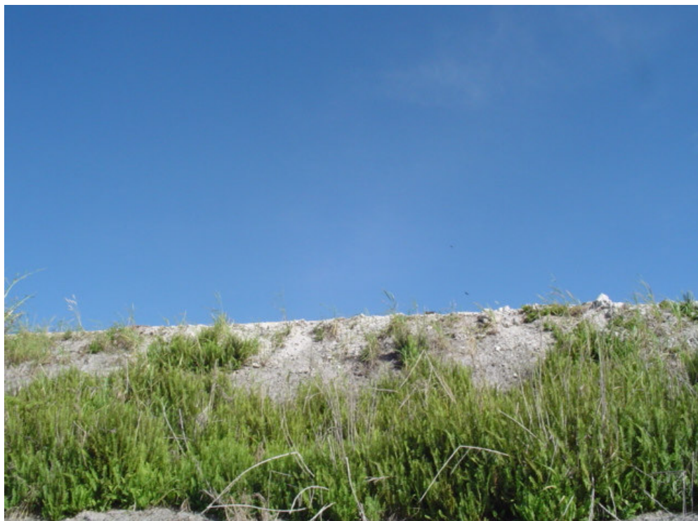
Figura 5.9 – Falha devido ao escoamento superficial de água ácida
