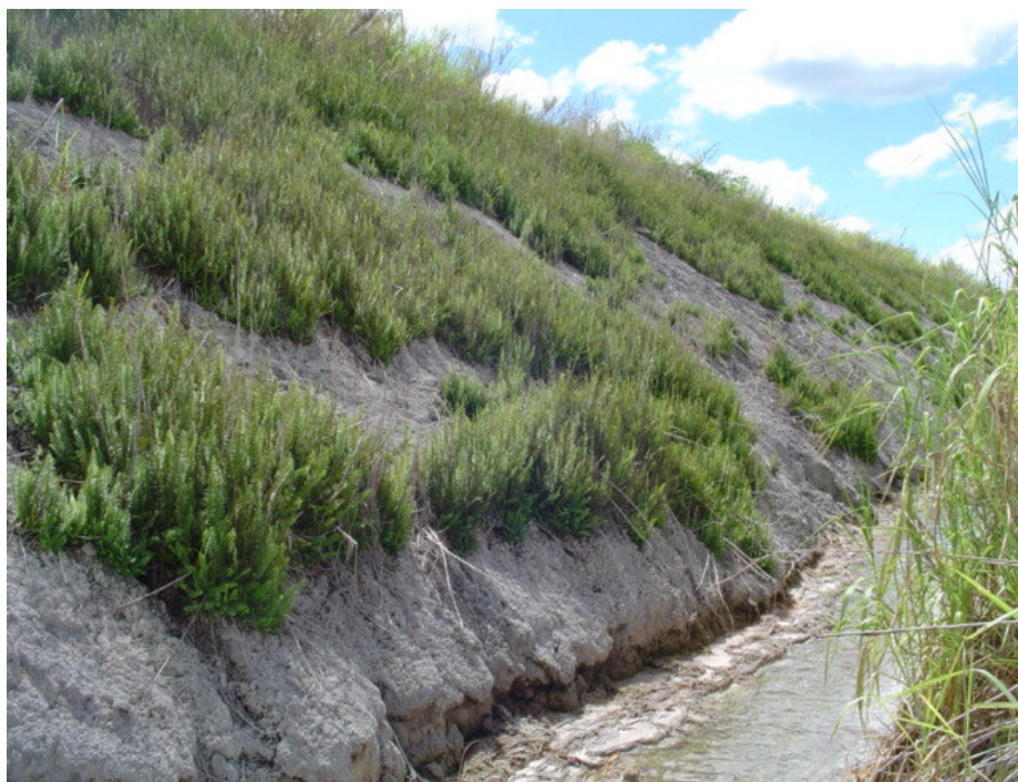
Figura 5.8 - Falha devido a exudação de água ácida ou ascensão capilar
