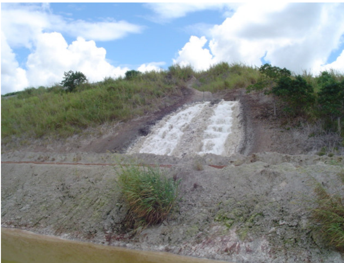
Figura 5.10 - Falha devido ao “Spray” da cachoeira de drenagem
