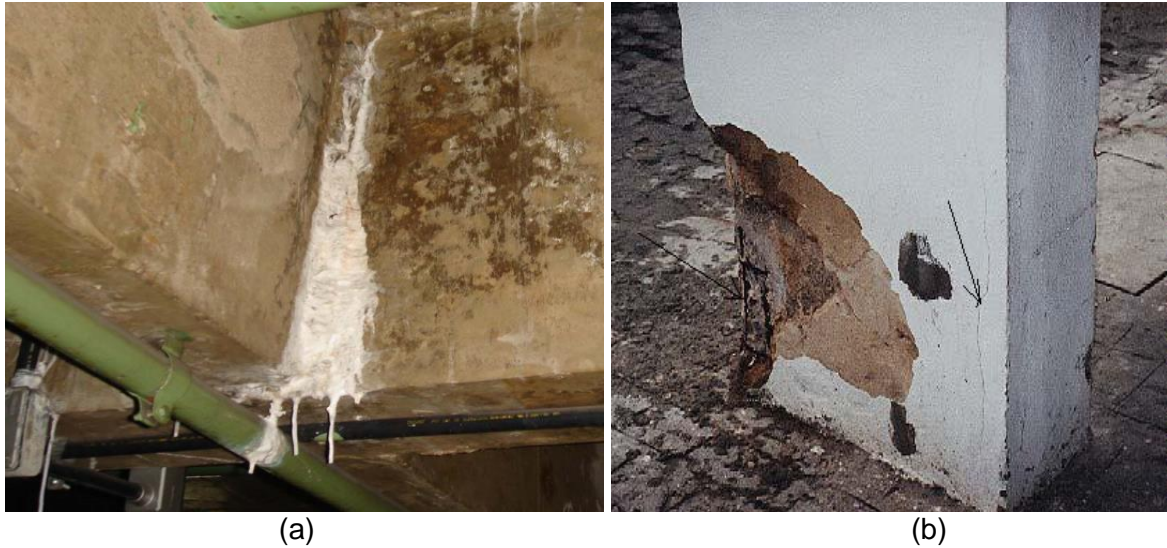
Figura 1 – Patologia de (a) eflorescência em vigas e (b) corrosão em armaduras. Fonte: SOUZA, 2008.
