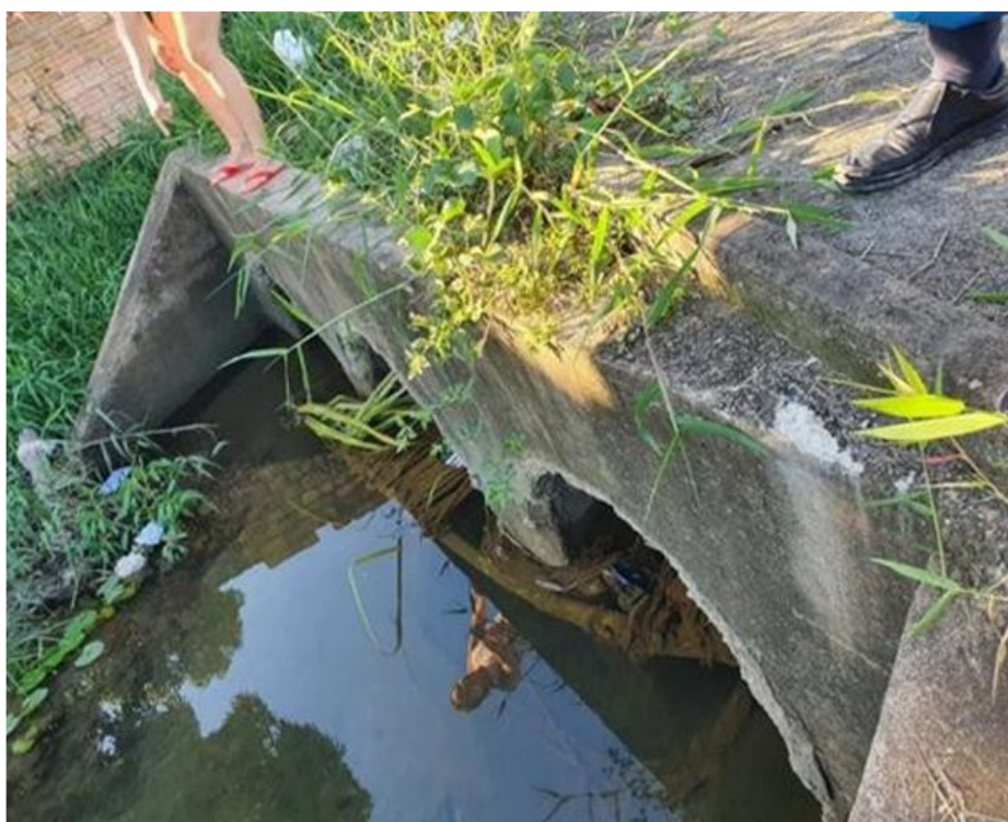
Figura 33 – Imagem da tubulação que está sob a Av. Ataíde Teive, que se encontra a jusante da Lagoa Alvorada e está parcialmente obstruída.
