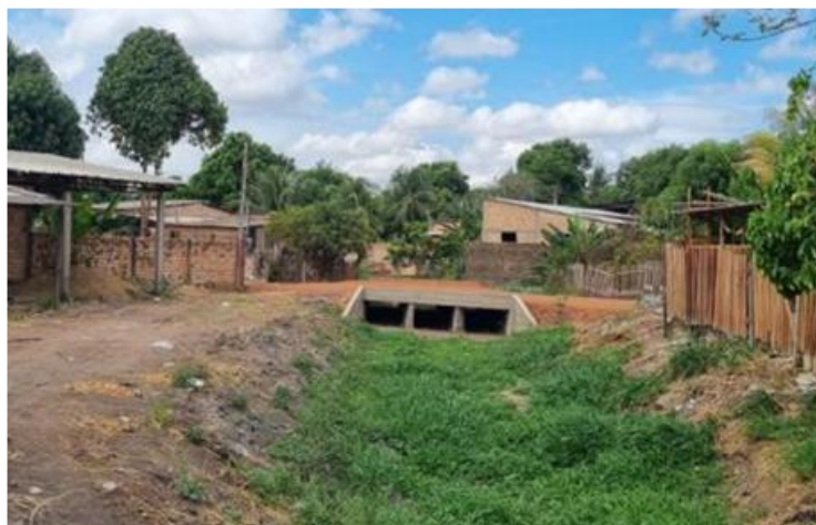
Figura 34 – Imagem da tubulação que está sob a rua B, que se encontra a jusante da Lagoa Alvorada, recém-inaugurada.
