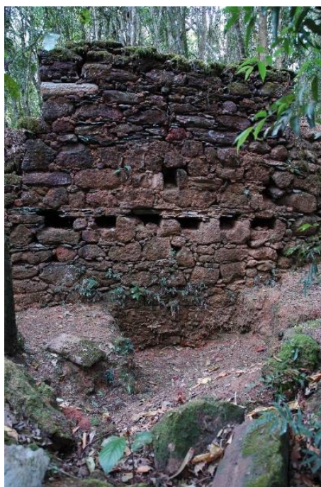
FIGURA 77 - Pátio: Muro 1 - vista dos vãos com encaixes para barrotes – 2
