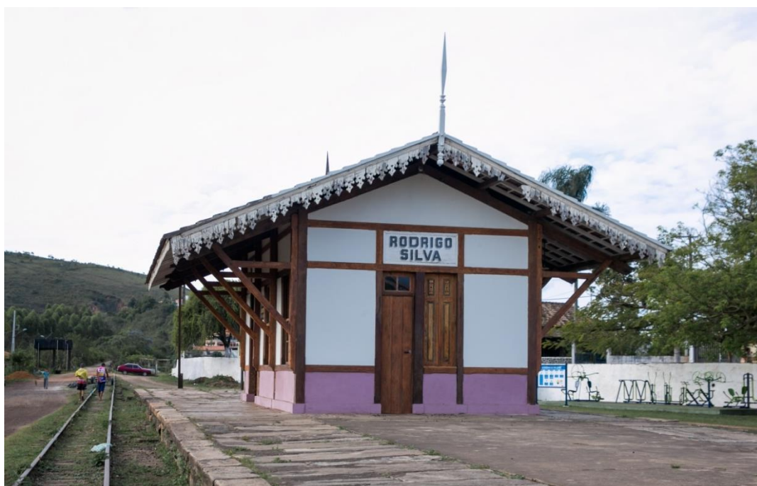
FIGURA 58 - Estação de Rodrigo Silva. Lambrequim em mau estado de conservação no telhado
