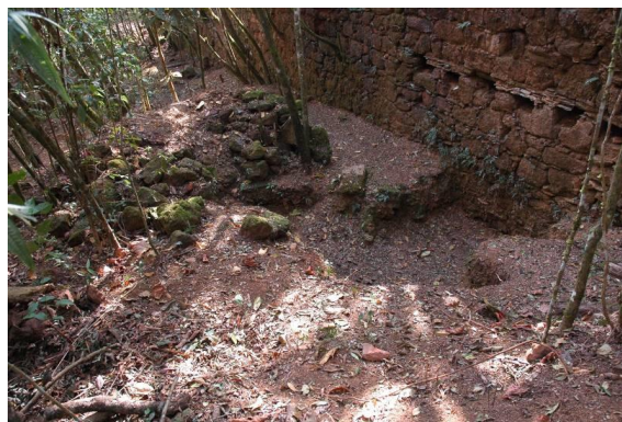
FIGURA 76 - Pátio: Muro 1 - vista dos vãos com encaixes para barrotes
