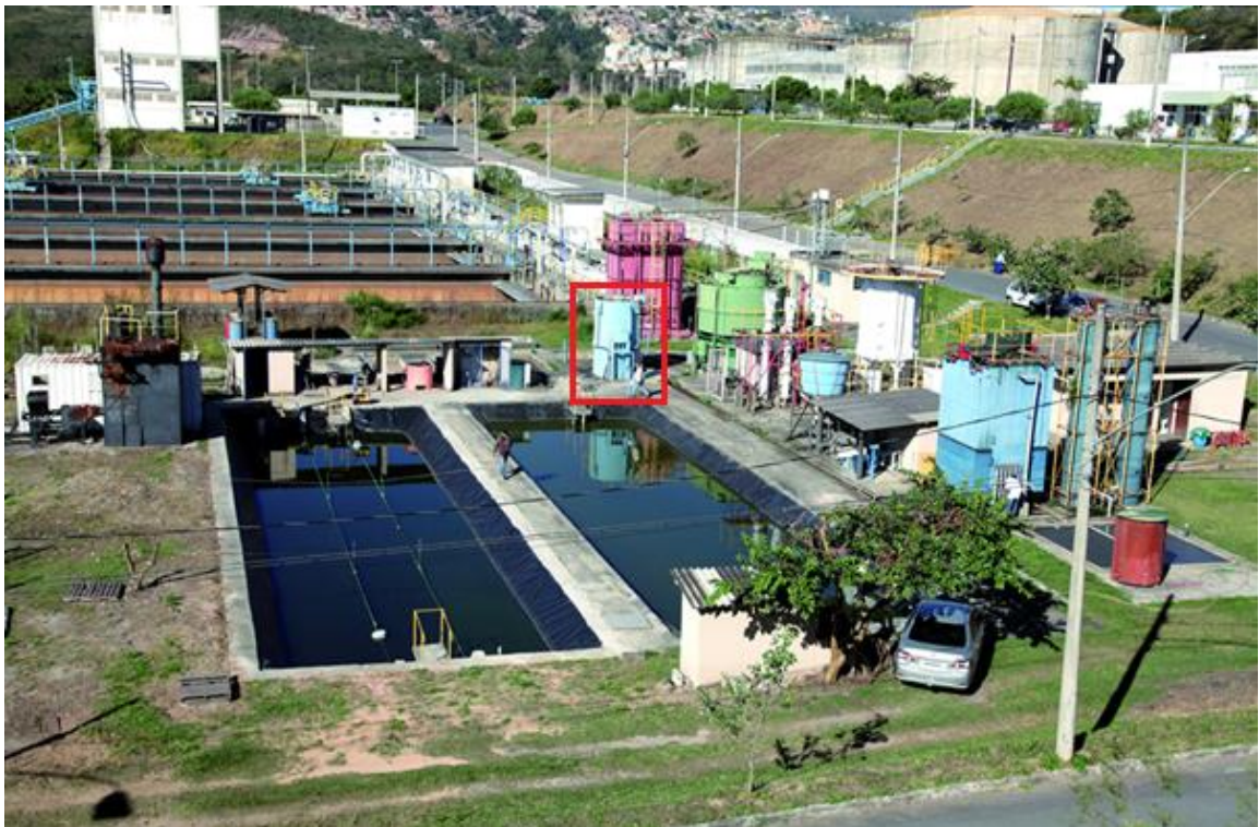
Figura 4.2 – Foto do CEPTS (com destaque para o reator UASB utilizado no experimento)
