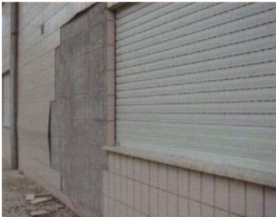
Figura 09: Descolamento por empolamento
