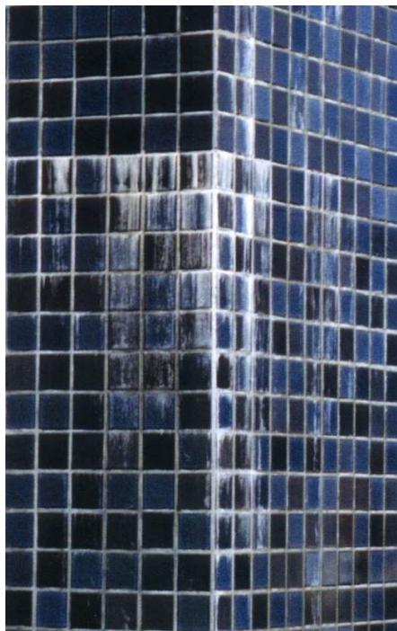
Figura 07: Eflorescência em fachada cerâmica
