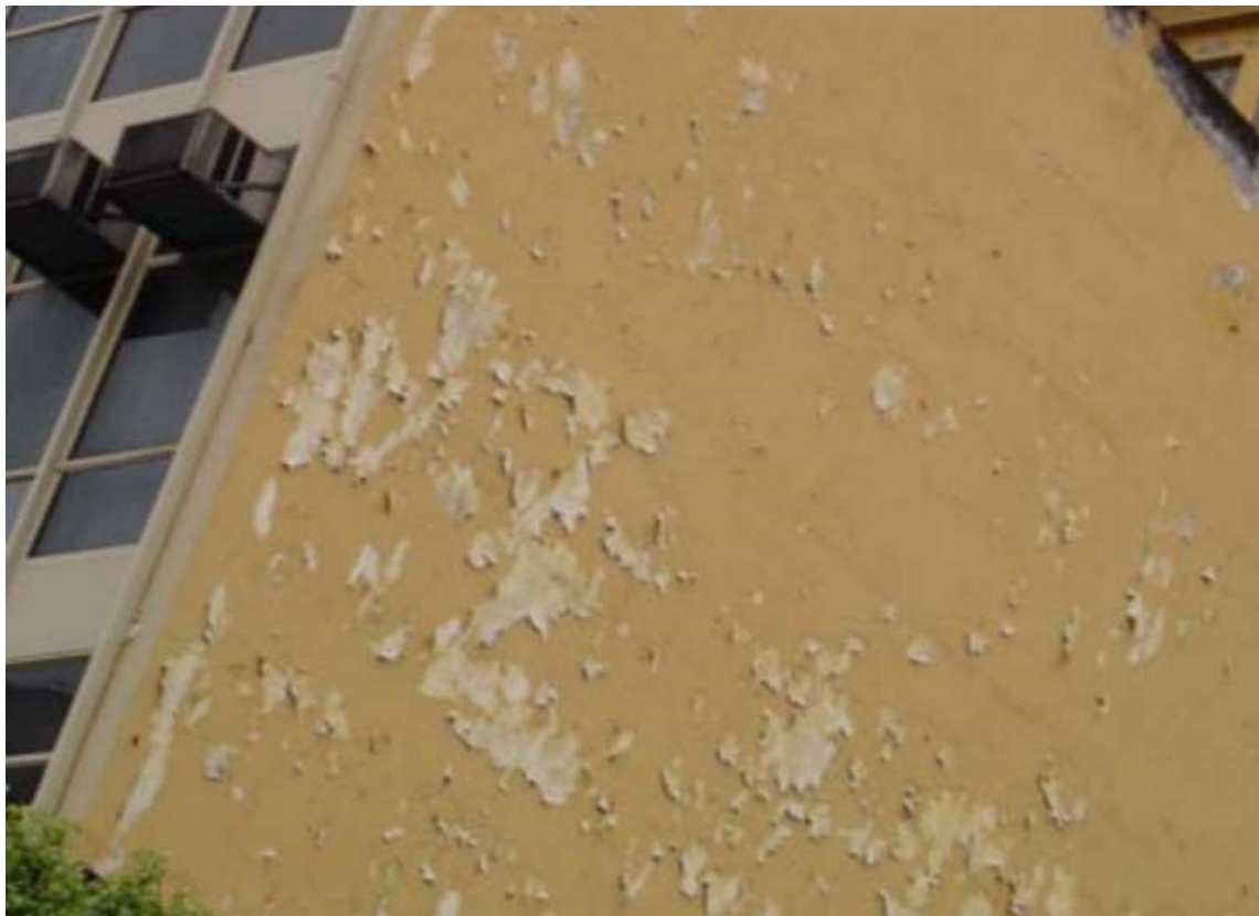
Figura 12: Aspecto de descascamento
