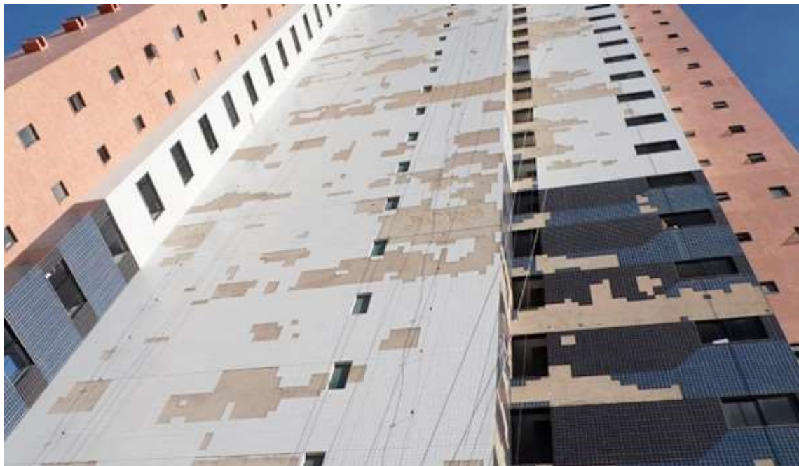
Figura 10: Descolamento em placas
