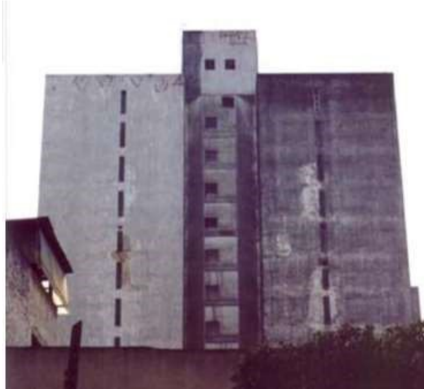
Figura 16: Aspecto mofo ou bolor
