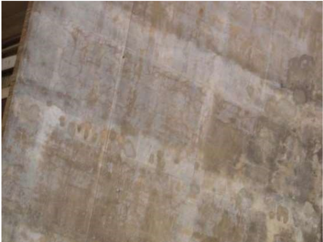
Figura 14: Aspecto de calcinação
