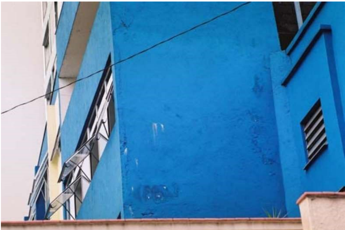
Figura 11: Aspecto de eflorescência
