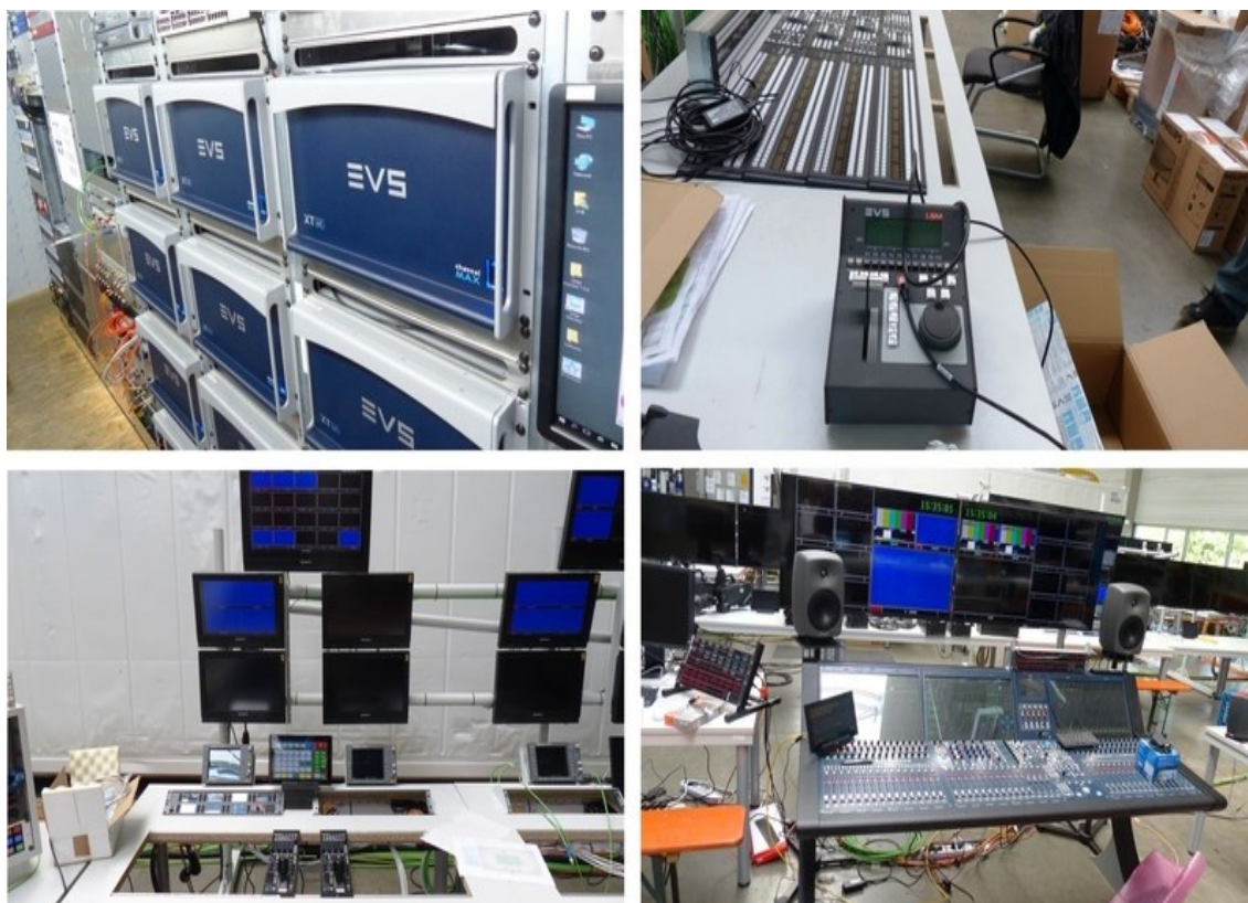
Figura 13: Coletânea de fotografias dos ERC (Equipment Room Container) russos. Fonte: Reprodução de imagens produzidas pela FIFA.
