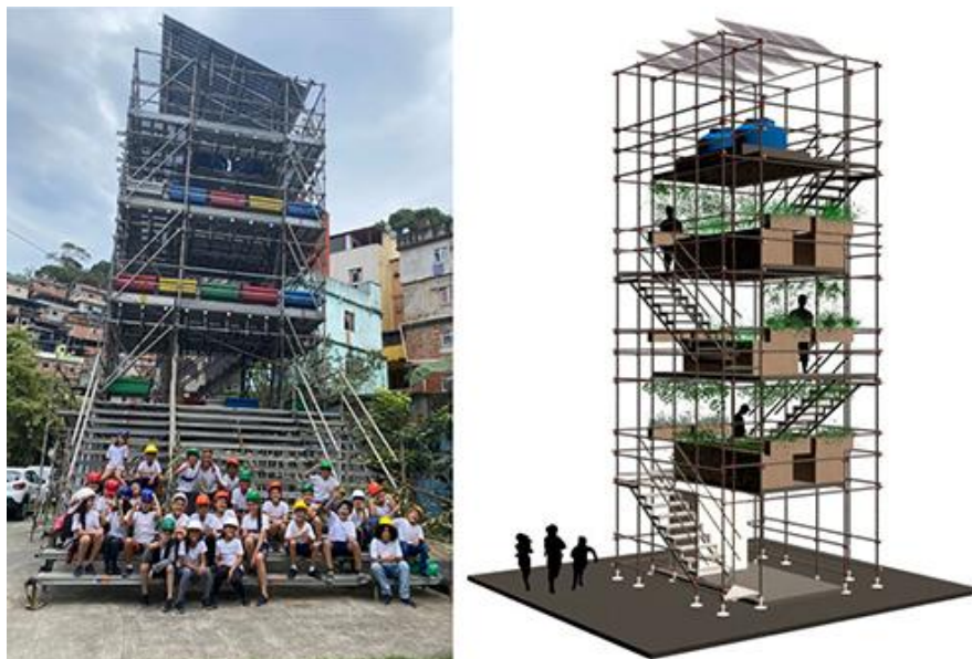
Imagem 1: Torre Verde, instalada na favela da Rocinha, Rio de Janeiro (RJ) . Fonte: Cruz (2025).
