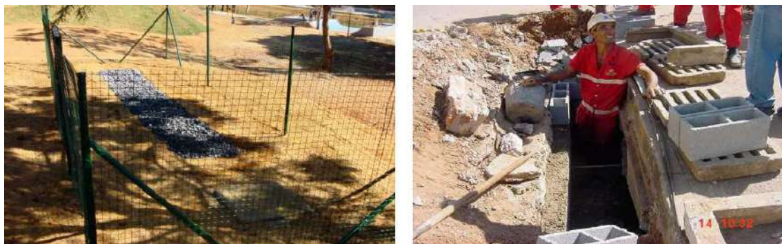
Figura 16: trincheira de infiltração e execução de boca de lobo permeável em rua
