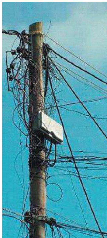
Figura 2.3: Exemplo de Perdas Não Técnicas por fraude de conexão em rede de distribuição aérea Fonte: ANEEL (2005) Textos para discussão II
