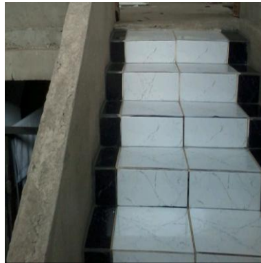
Escada de acesso ao Terraço, construção incompleta.
