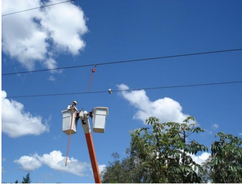
Figura 6.7 Detalhe da instalação do sensor Power Donut-5106 no vão 50-51.
