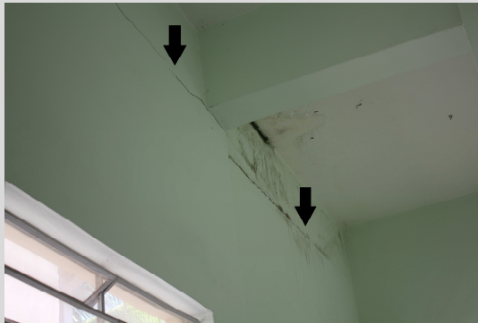
FIGURA 37 – [INFILTRAÇÃO NO PAVIMENTO TÉRREO]
