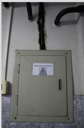
FIGURA 18 – [QUADRO ELÉTRICO COM TUBULAÇÃO APARENTE]
