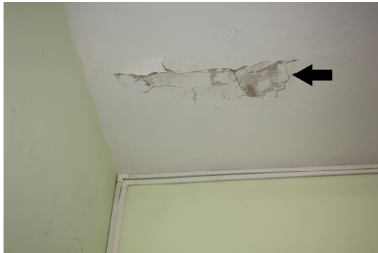
FIGURA 39 – [RUPTURA PARCIAL DA LAJE]
