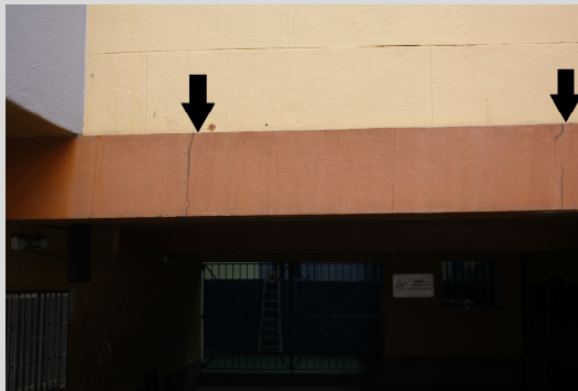
FIGURA 31 – [TRINCAS EM VIGA FLETIDA]
