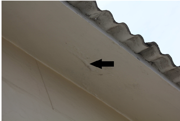
FIGURA 44 – [DETALHE BEIRAL COM INFILTRAÇÃO]
