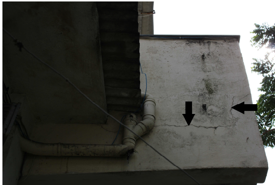
FIGURA 47 – [TRINCA POR DIFERENÇA DE DILATAÇÃO TÉRMICA]
