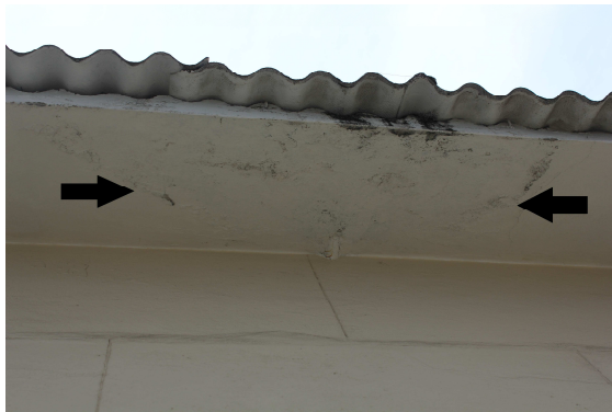
FIGURA 43 – [BEIRAL COM INFILTRAÇÃO]
