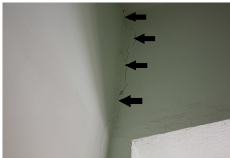
FIGURA 41 – [TRINCA POR DILATAÇÃO TÉRMICA]
