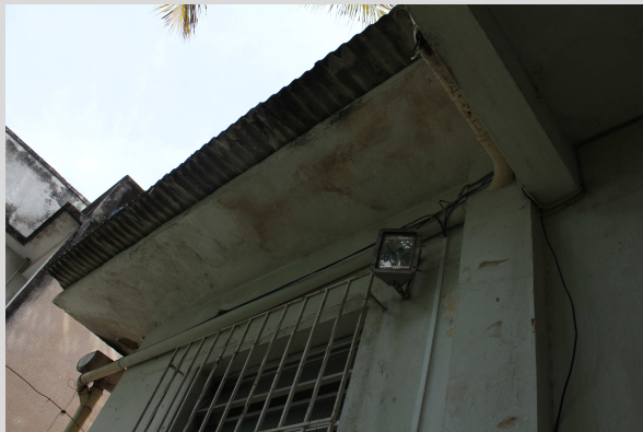
FIGURA 45 – [BEIRAL COM INFILTRAÇÃO]
