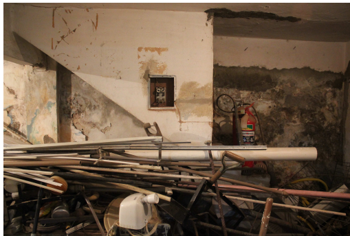
FIGURA 61 – [UMIDADE NO PORÃO]
