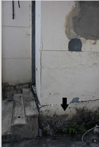
FIGURA 60 – [INFILTRAÇÃO PROVENIENTE DO SOLO]
