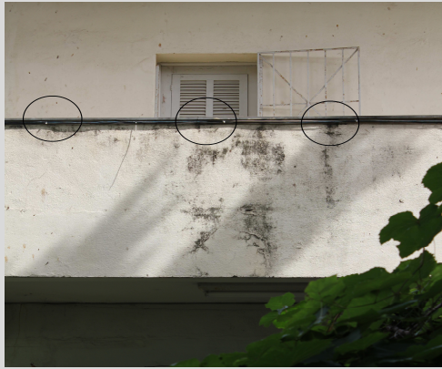
FIGURA 56 – [INFILTRAÇÃO ENTRE CERÂMICAS]
