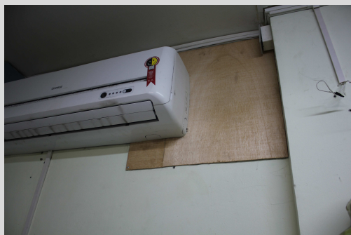
FIGURA 20 – [CANALETAS SEM ACABAMENTO]
