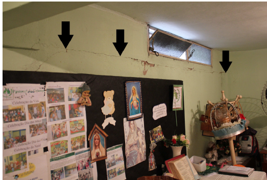
FIGURA 59 – [TRINCA POR MOTIVO DESCONHECIDO]
