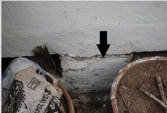
FIGURA 48 – [TRINCA DE REVESTIMENTO]
