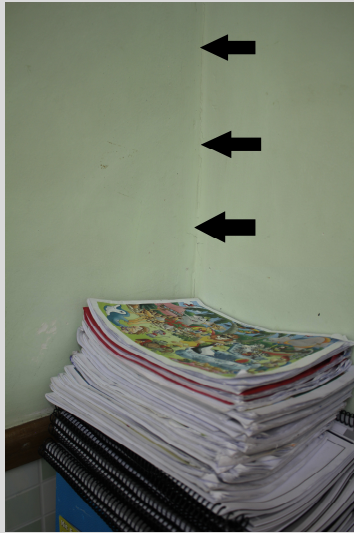
FIGURA 40 – [TRINCA POR DILATAÇÃO TÉRMICA]
