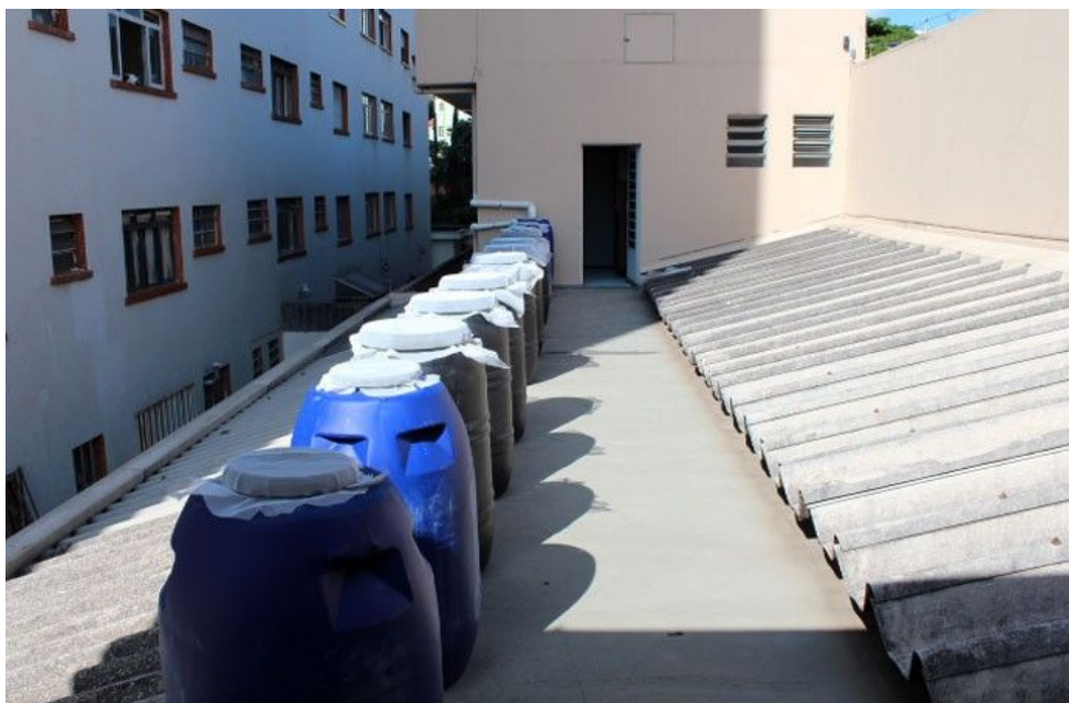
FIGURA 12 - Sistema de “bombonas” interligadas para fornecimento de água
