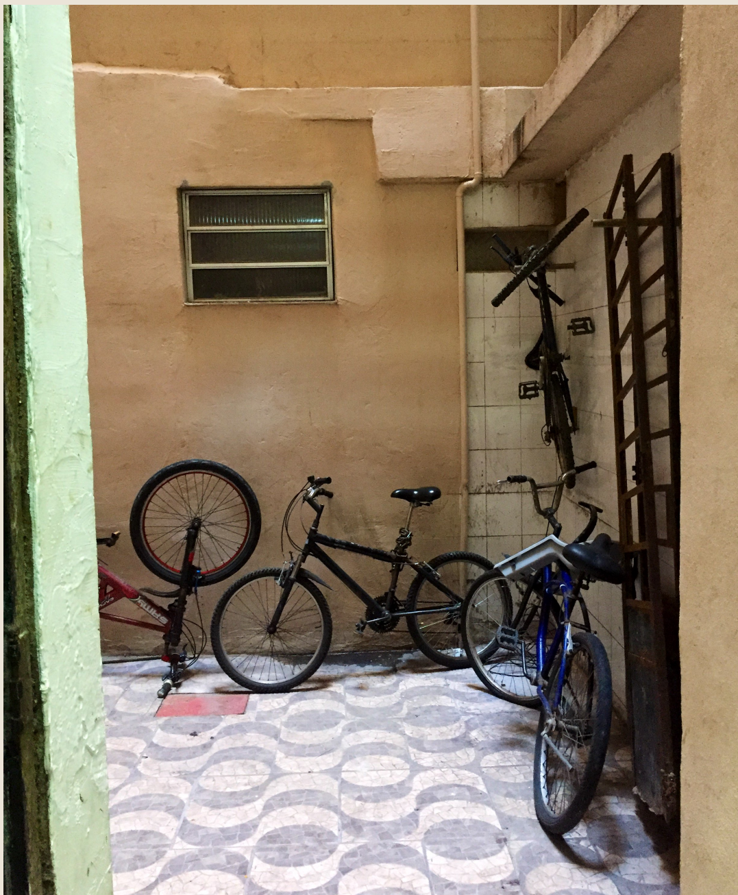
Figura 22: Fosso do edifício da Manoel Congo, que dá acesso à Casa de Samba e onde costumam ficar bicicletas de moradores. Fonte: Acervo próprio, 2019.
