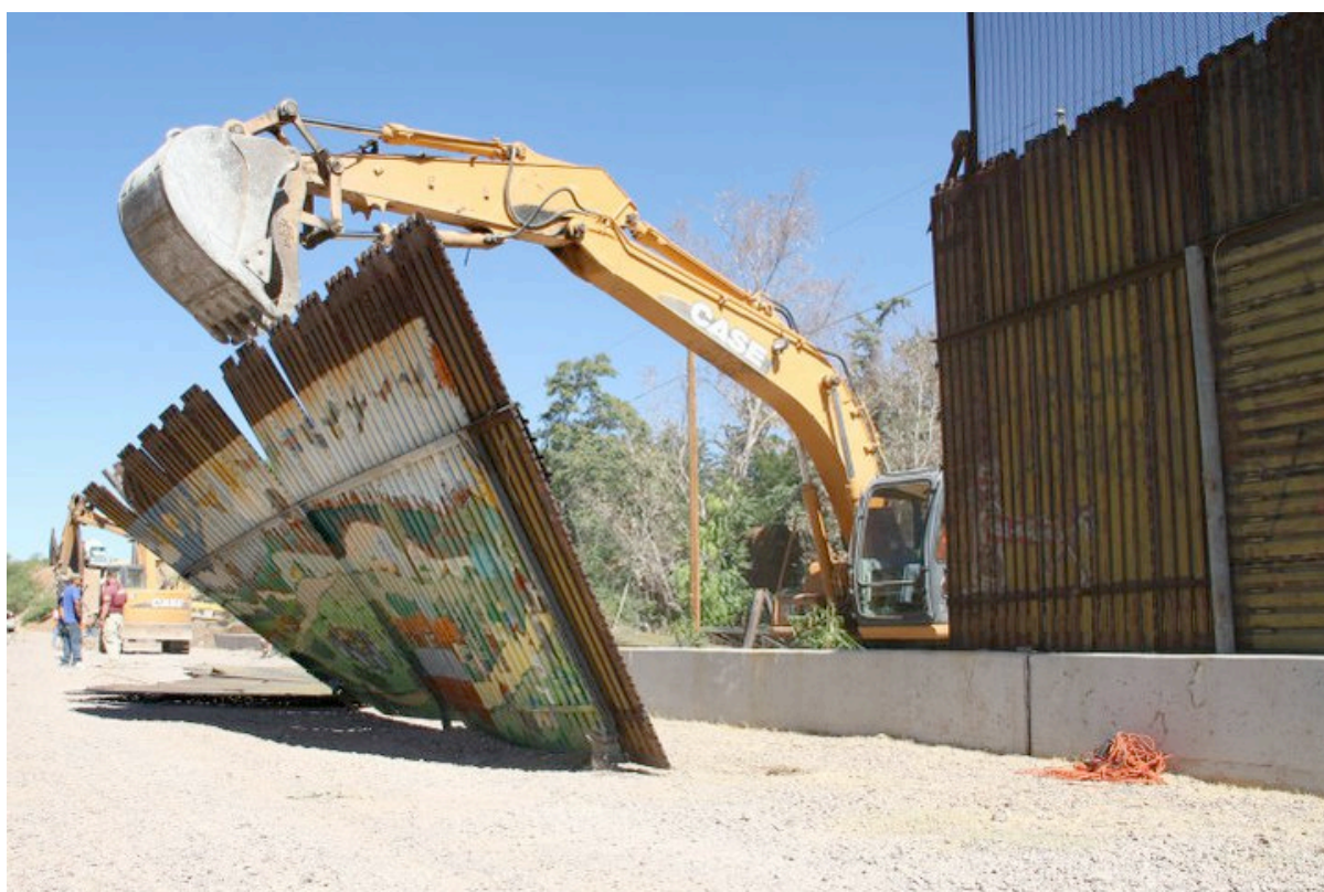
Figura 78. Remoção do Muro Internacional (Mural Taniperla), Nogales Sonora-Arizona, 2011. Fonte: Fotografia de Roman Perea.
