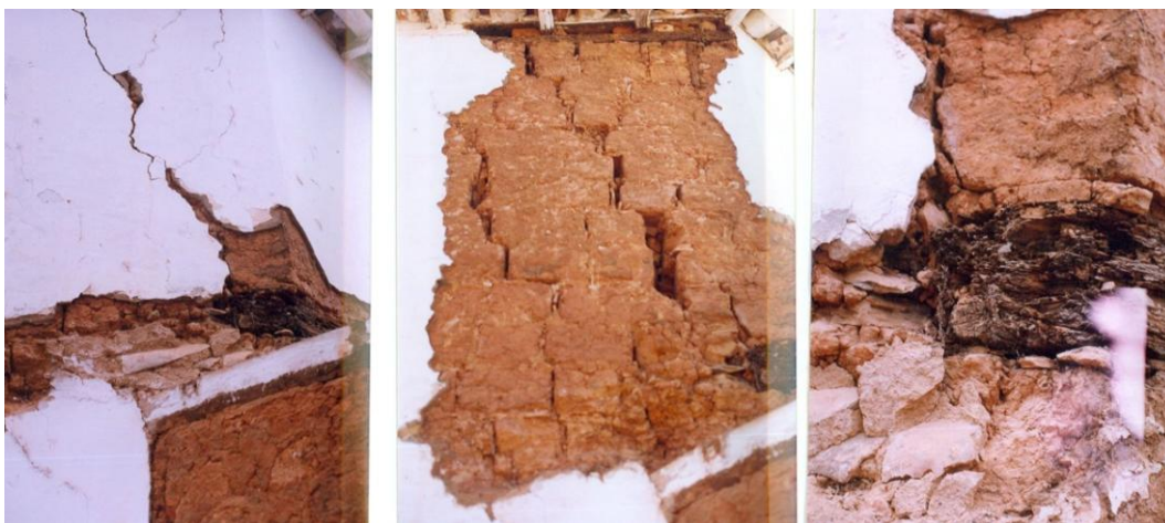
Figura 107 - Fotos 107a, 107b e 107c: Detalhe do revestimento. Após a retirada do revestimento observou-se a irregularidade do aparelho da alvenaria com formação de juntas aprumadas e o afastamento entre os componentes de adobes ocasionados por movimentações na edificação; a propagação da fissura deu-se a partir da interface da parede com a cobertura em direção a extremidade da verga de madeira sobre a porta principal, ponto onde observa-se um ligeiro abatimento do painel ocasionado pela deterioração da madeira.
