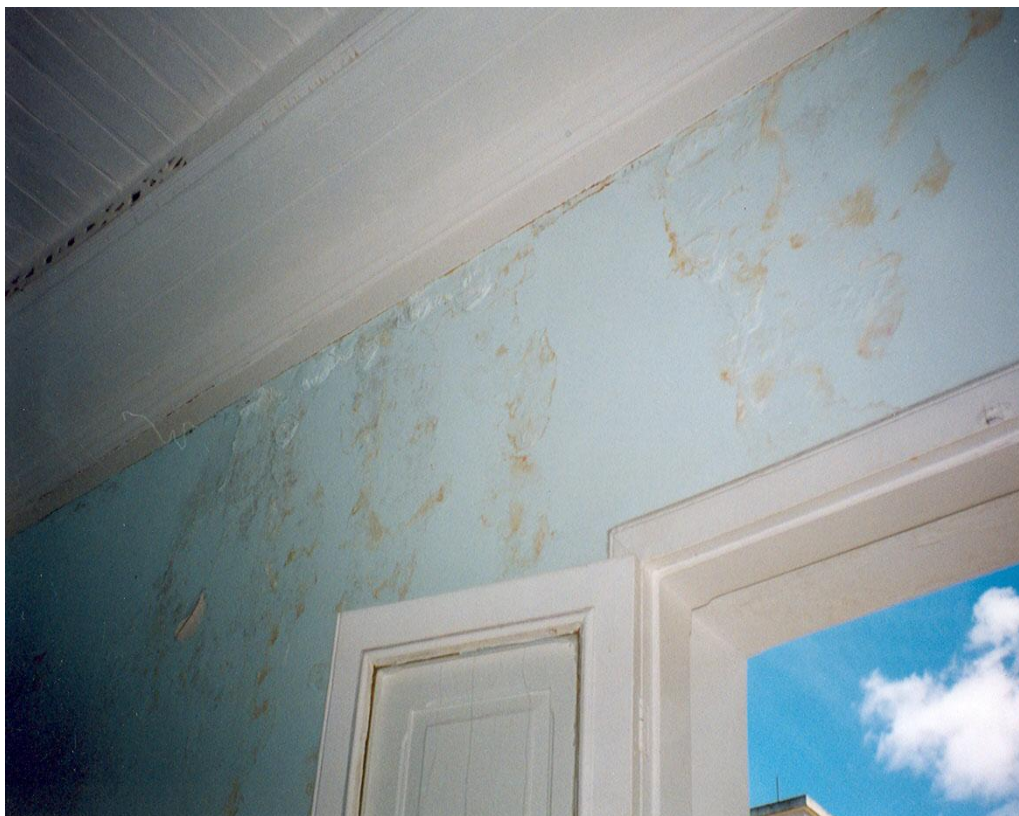
Figura 41 - Manchas de vesículas causadas devido a umidade e aplicação de materiais adulterados Casa Rua da Bahia – Belo Horizonte - MG Fonte: Acervo do IEPHA.
