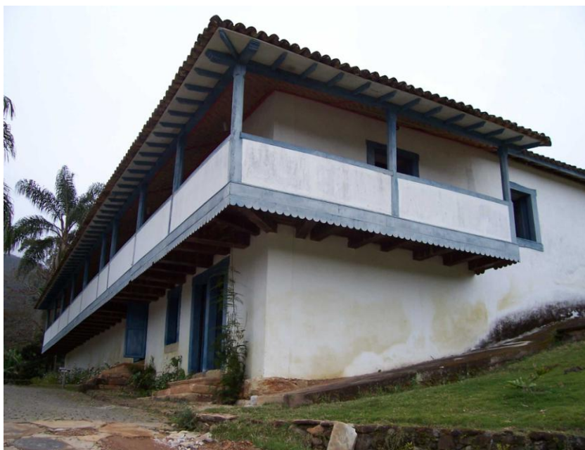
Figura 56 - Manchas de umidade provenientes de vazamentos das instalações ou umidade accidental Fazenda Carreiras – Ouro Branco - MG Fonte: Acervo do IEPHA.
