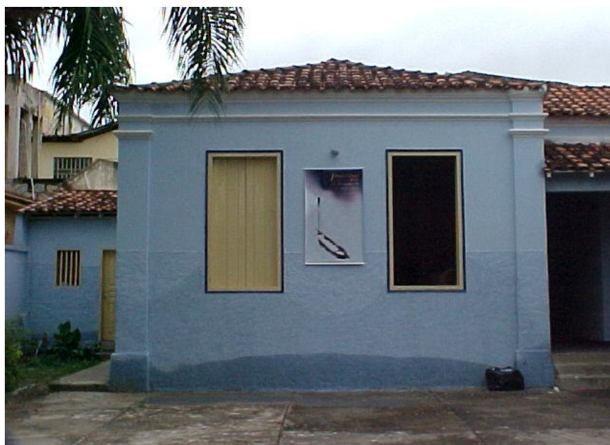
Figura 58 - Manchas de umidade Residência Montes Claros - MG Fonte: Acervo do IEPHA.
