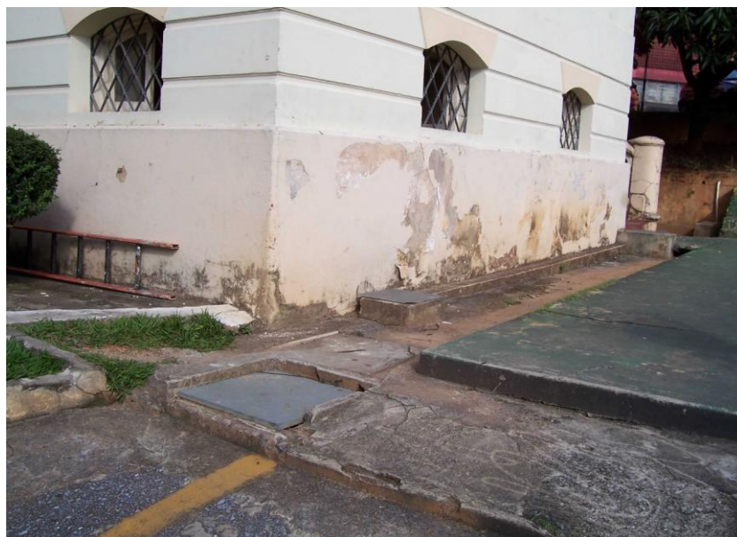
Figura 57 - Manchas de umidade 1º Batalhão do Corpo de Bombeiros de BH Fonte: Acervo do IEPHA.
