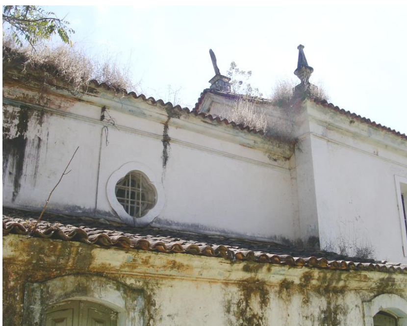
Figura 48 - Manchas de bolor e presença de vegetação junto a fachada causada pela falta de manutenção e infiltração Fonte: Acervo do IEPHA.
