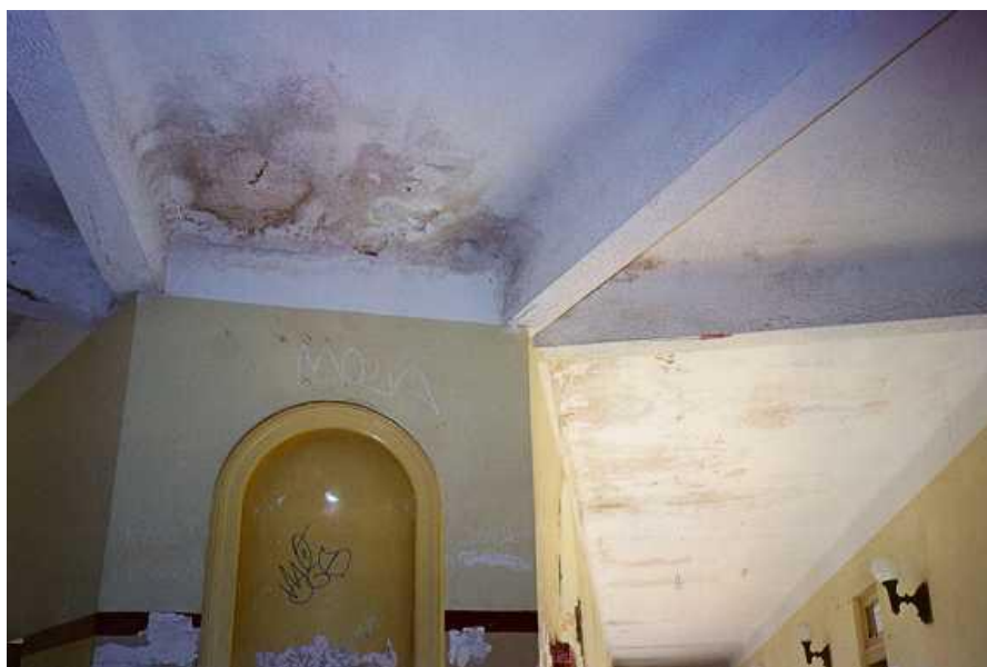
Figura 59 - Manchas de umidade E.E. Pedro II – BH - MG Fonte: Acervo do IEPHA.
