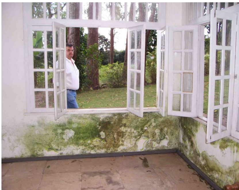
Figura 47 - Manchas de bolor nas paredes internas devido a umidade ascendente Museu Emerick Marcier – Barbacena - MG Fonte: Acervo do IEPHA.
