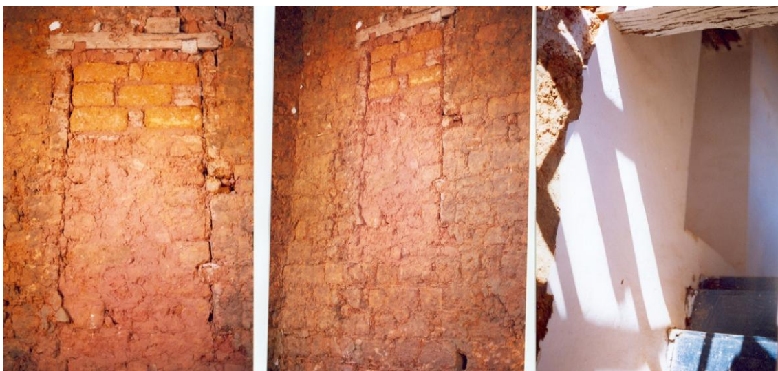
Figura 125 - Fotos 125a,125b e 125c: Parede 13 após a retirada do reboco, observou-se a existência de um vão de parede fechado, em data imprecisa, com emprego de adobes. Pela posição que ocupa na parede, pode supor sua função como púlpito. O fechamento do vão conformou uma reentrância (nicho) na face oposta da parede – na área de acesso à torre na torre da sineira. Observar verga de madeira sobre o vão. Esse vão foi reaberto na atual intervenção por orientação do IEPHA/MG propiciando melhores condições de circulação de ar e iluminação internamente à nave.
