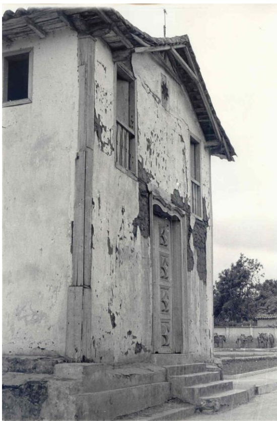
Figura 54 - Descolamento com empolamento da fachada principal Fonte: Acervo do IEPHA.
