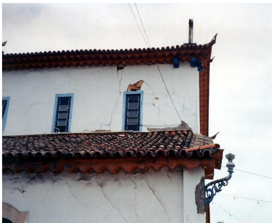
Figura 61 - Fissuras no revestimento devido a fatores externos aos revestimentos Igreja Nossa Senhora Conceição – Conselheiro Lafaiete - MG
