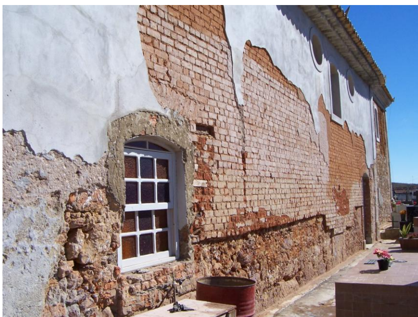
Figura 51 - Descolamentos de revestimentos Fonte: Acervo do IEPHA.
