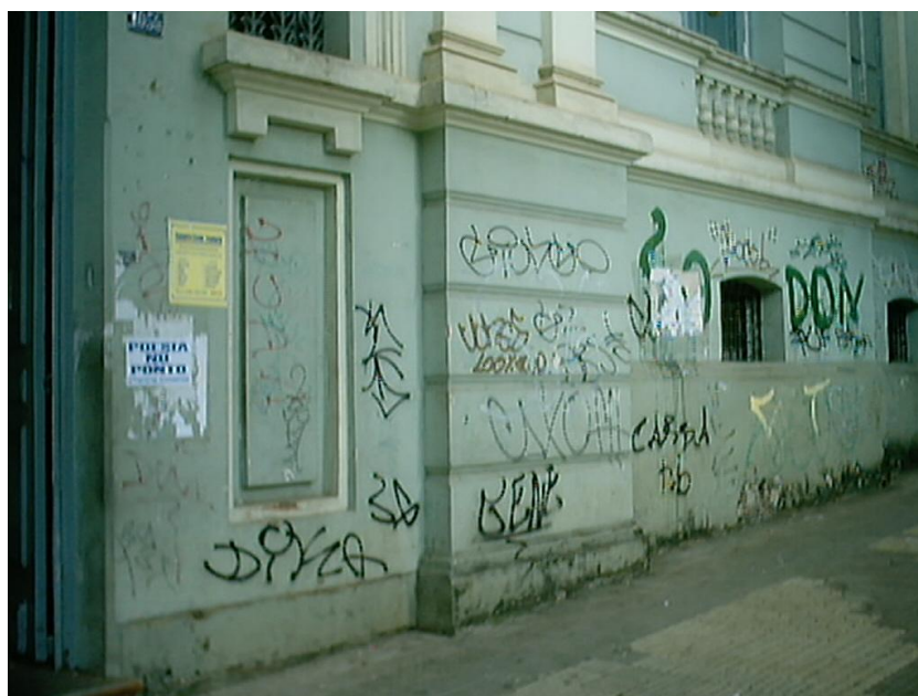
FIGURA 64 - Manchas de vandalismo Escola Barão do Rio Branco – Savassi – Belo Horizonte Fonte: Acervo do IEPHA.
