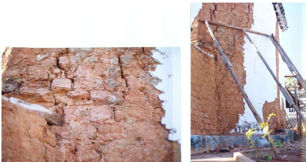
Figura 108 - Fotos 108a e 108b: Detalhe do encontro das paredes: o ângulo de concorrência das paredes ( 135^\circ ) e a pequena extensão dos panos de parede ( \sim 2,50\text{m} ) dificultam sua manutenção do aparelho da alvenaria com juntas amarradas e determinaram a conformação de juntas a prumo por 3 ou mais fiadas.
