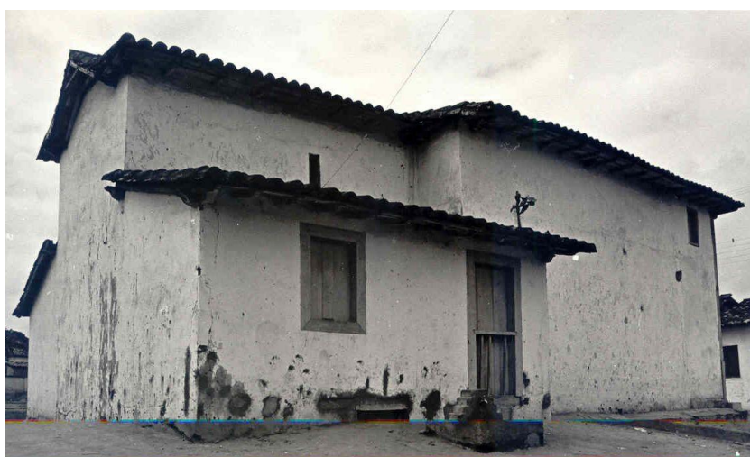
Figura 55 - Descolamento com empolamento das fachadas lateral e posterior Fonte: Acervo do IEPHA.
