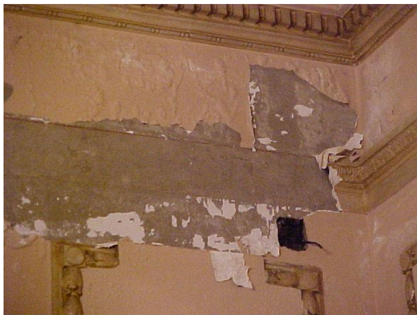
Figura 52 - Descolamento com pulverulência causado pela excessiva presença de sais Secretaria de Educação – Praça da Liberdade - BH Fonte: Acervo do IEPHA.
