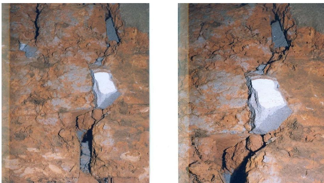
FIGURA 109 - Fotos 109a e 109b: Detalhe de painel de alvenaria evidenciando a tentativa de recuperação de fissuras através de seu preenchimento com argamassa muito rígida de cimento e areia, possivelmente na intervenção de 1980. Observa-se a incompatibilidade entre as argamassas de cimento e areia e os componentes de barro cru impossibilitando o processamento dos mecanismos de aderência entre ambos. Apesar disso, ficou evidenciado nesses pontos haver ocorrido a acomodação da edificação em nova posição de equilíbrio, uma vez que o destacamento entre os panos de paredes não evoluiu desde então, não sendo observado aberturas na interface adobe-argamassa
