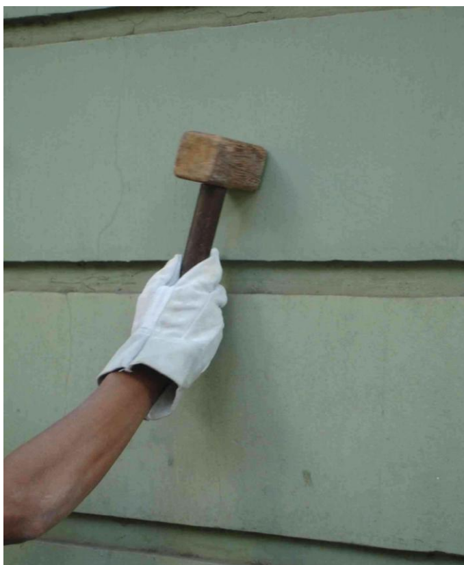
Figura 71 - Prospecções pontuais, com ferramenta apropriada para registro das partes comprometidas Fonte: Acervo do autor.
