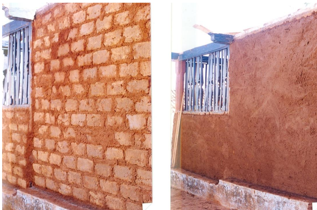
Figura 135 - Fotos 135a e 135b: Vista da parede 3 lateral esquerda do copiar. Essa parede foi em parte desmontada para correção do prumo e reestabelecimento da planeza afetada por deslocamento de um trecho do painel que projetou-se para fora de seu plano. Após retirada e reposição dos mesmos componentes de adobe, a parede recebeu a argamassa de emboço.
