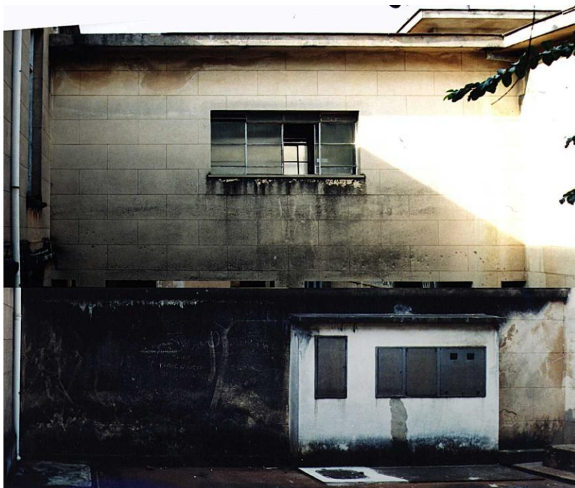
Figura 46 - Manchas de bolors devido a umidade e inexistência de sol Hospital Odilon Behrens – BH - MG Fonte: Acervo do IEPHA.
