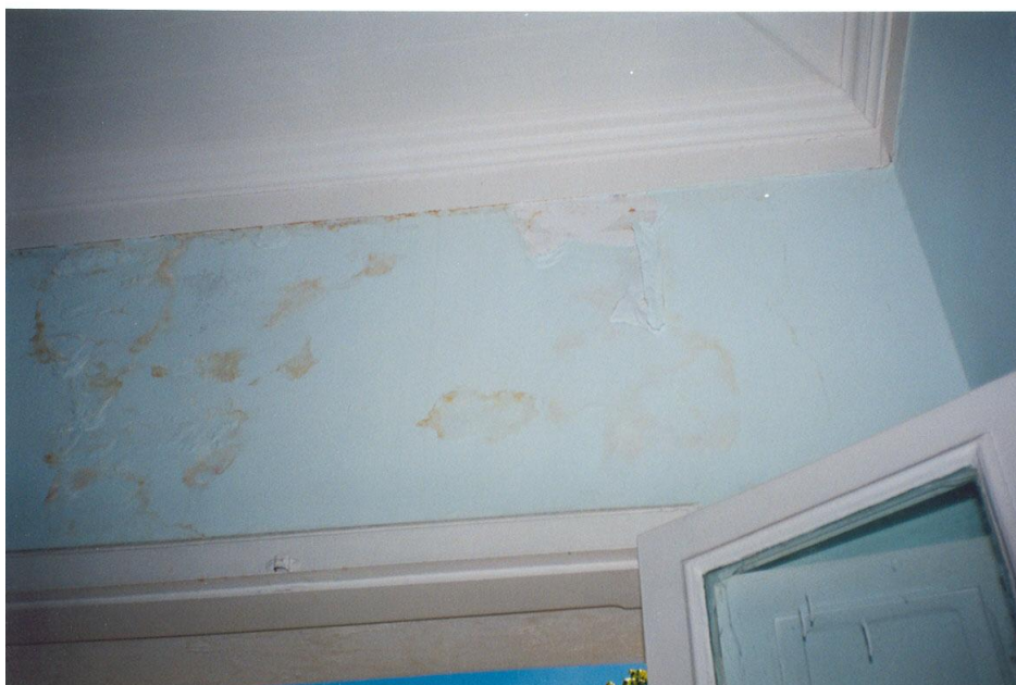
Figura 42 - Manchas de vesículas Casa Rua da Bahia – Belo Horizonte - MG Fonte: Acervo do IEPHA.
