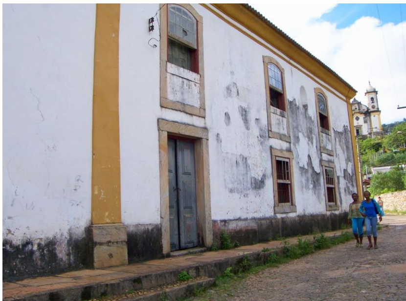
Figura 45 - Manchas de bolors junto a fachada devido a umidade e infiltrações Igreja Nossa Senhora do Rosário - MG Fonte: Acervo do IEPHA.
