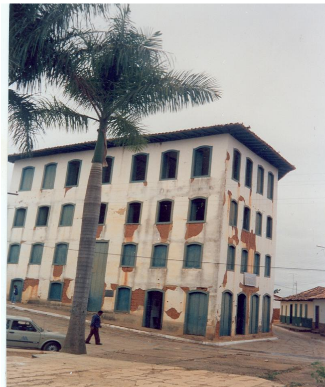
Figura 50 - Descolamentos de revestimentos das fachadas do sobradão em Minas Novas – Minas Gerais Fonte: Acervo do IEPHA.
