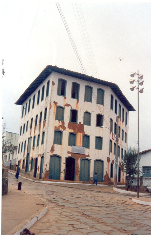
Figura 49 - Descolamentos de revestimentos das fachadas do Sobradão em Minas Novas – Minas Gerais Fonte: Acervo do IEPHA.
