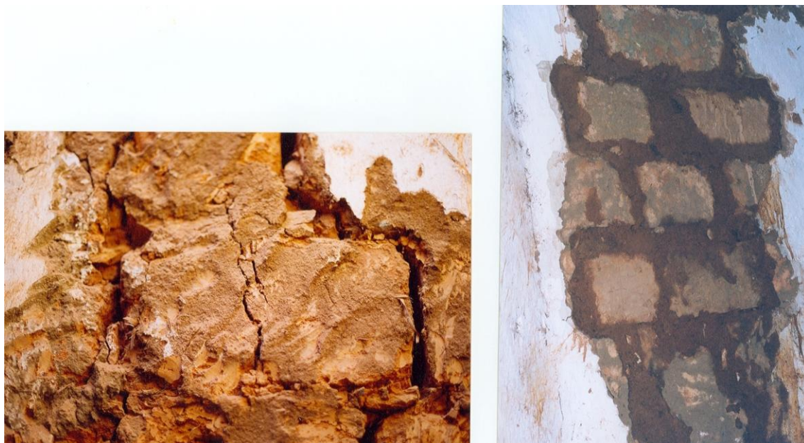
Figura 124 - Foto 38: Detalhe da face interna da parede 9, no único ponto onde observou-se fissuração no componente de adobe. Foto 39: Recomposição da face interna parede 11 com substituição de apenas um componente de adobe e rejuntamento das juntas com argamassa de terra e areia.
