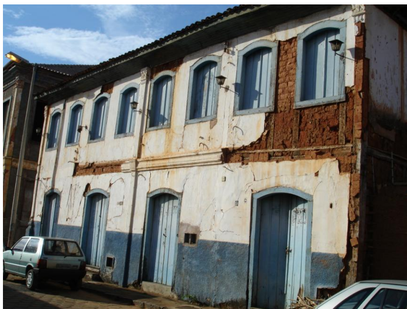
Figura 1 - Detalhe do estado de conservação das fachadas que atualmente estão sendo alvo do descomprometimento dos responsáveis pela sua guarda Fonte: Acervo do IEPHA.
