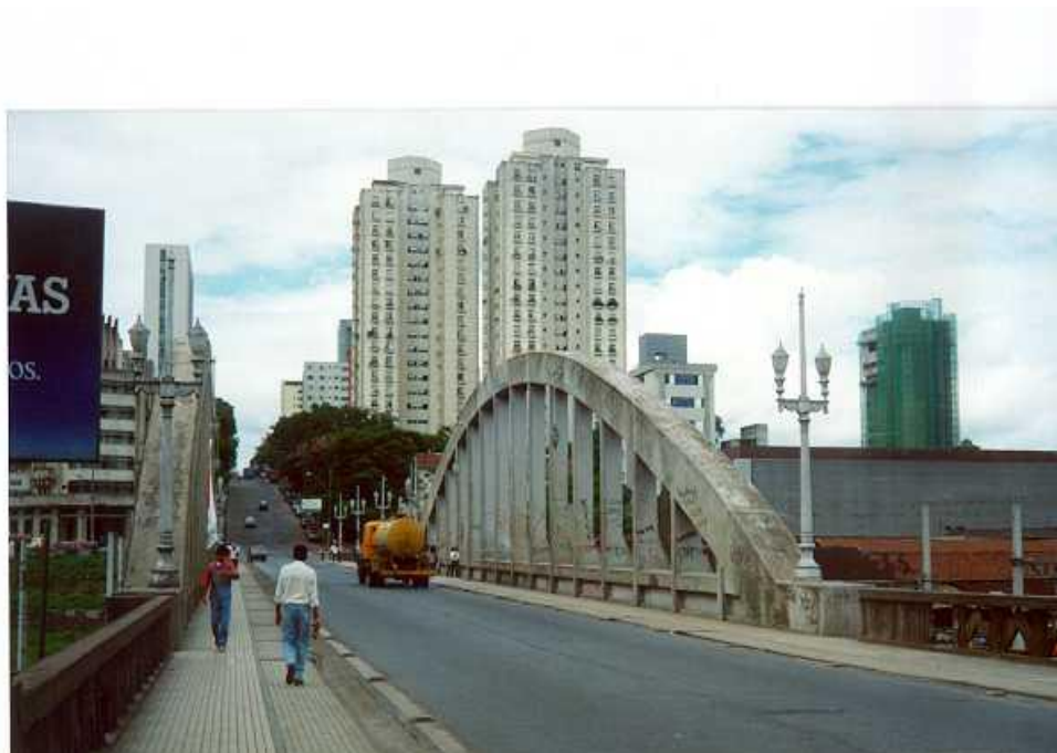
Figura 67 - Manchas de vandalismo Viaduto Santa Tereza – Belo Horizonte Fonte: Acervo do IEPHA.
