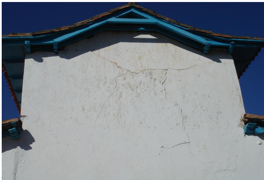
Figura 60 - Fissuras no revestimento causado pelo recalque do solo e fundação Igreja Nossa Senhora Conceição – Conselheiro Lafaiete - MG Fonte: Acervo do IEPHA.
