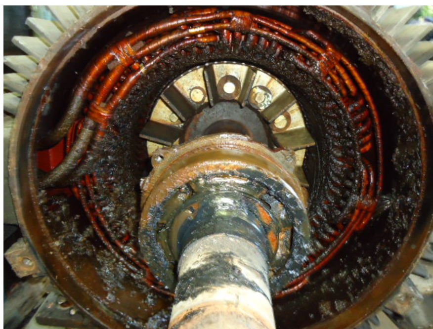
Figura 3.21 – Estator de um motor com o isolamento contaminado por óleo/sujeira.
