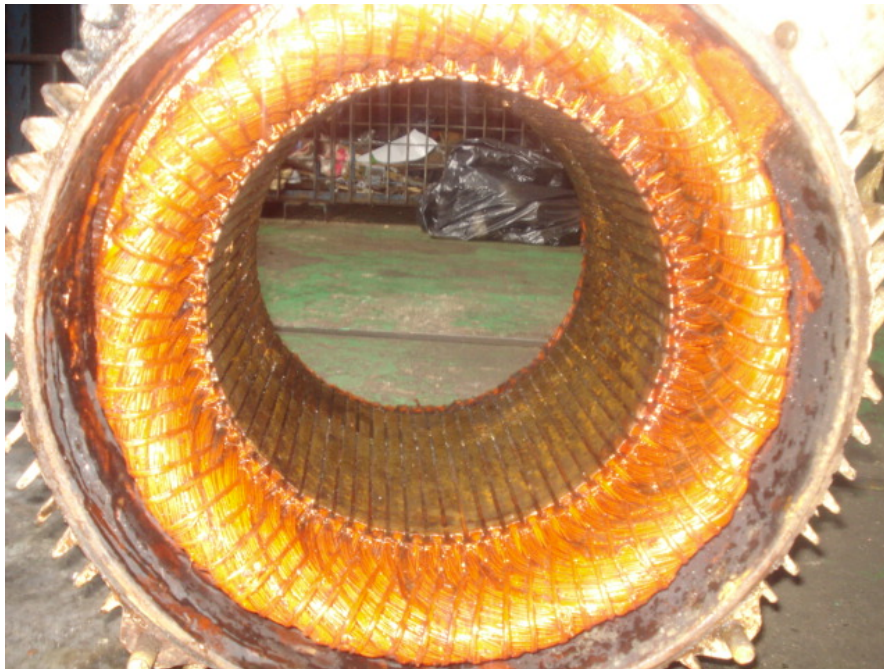
Figura 3.17 – Estator de um motor com o isolamento apresentando umidade.
