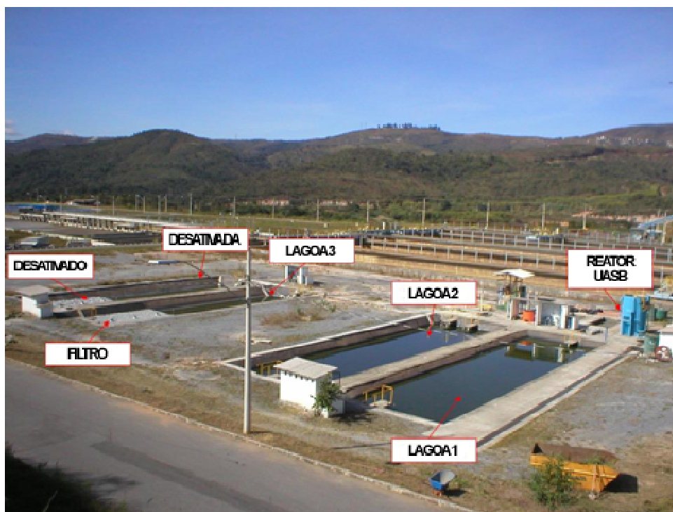
Figura 4.1 - Vista do sistema reator UASB – Lagoas de polimento (1, 2, 3) e filtro de pedra.
