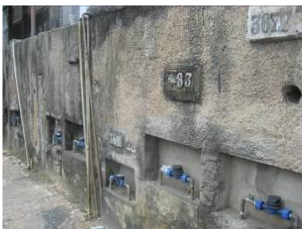
FIGURA 24: Grande quantidade de registros da COPASA no muro de arrimo existente entre o “lado de cima” e a Avenida Afonso Pena indica elevada densidade populacional. Foto da autora.
