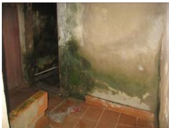
FIGURA 23: Detalhe da condição insalubre de uma casa cujas paredes são atingidas pela água que se acumula nos fundos da Vila em períodos chuvosos. Foto da autora.
