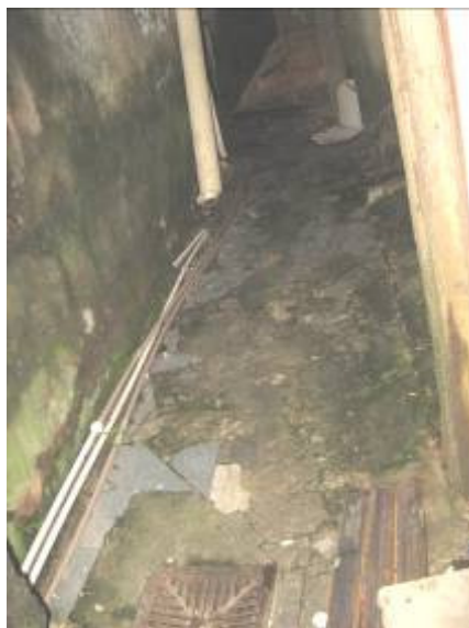
FIGURA 22: Detalhe da pavimentação irregular e precária no beco do “lado de cima”. Percebe-se a umidade do piso e das paredes das casas.
