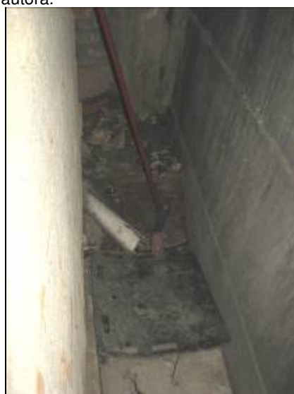
FIGURA 21: Detalhe do tubo de esgoto saindo de uma residência e caixa de passagem que não possui vedação adequada no beco do “lado de cima” da Vila Santa Isabel. Foto da autora.
