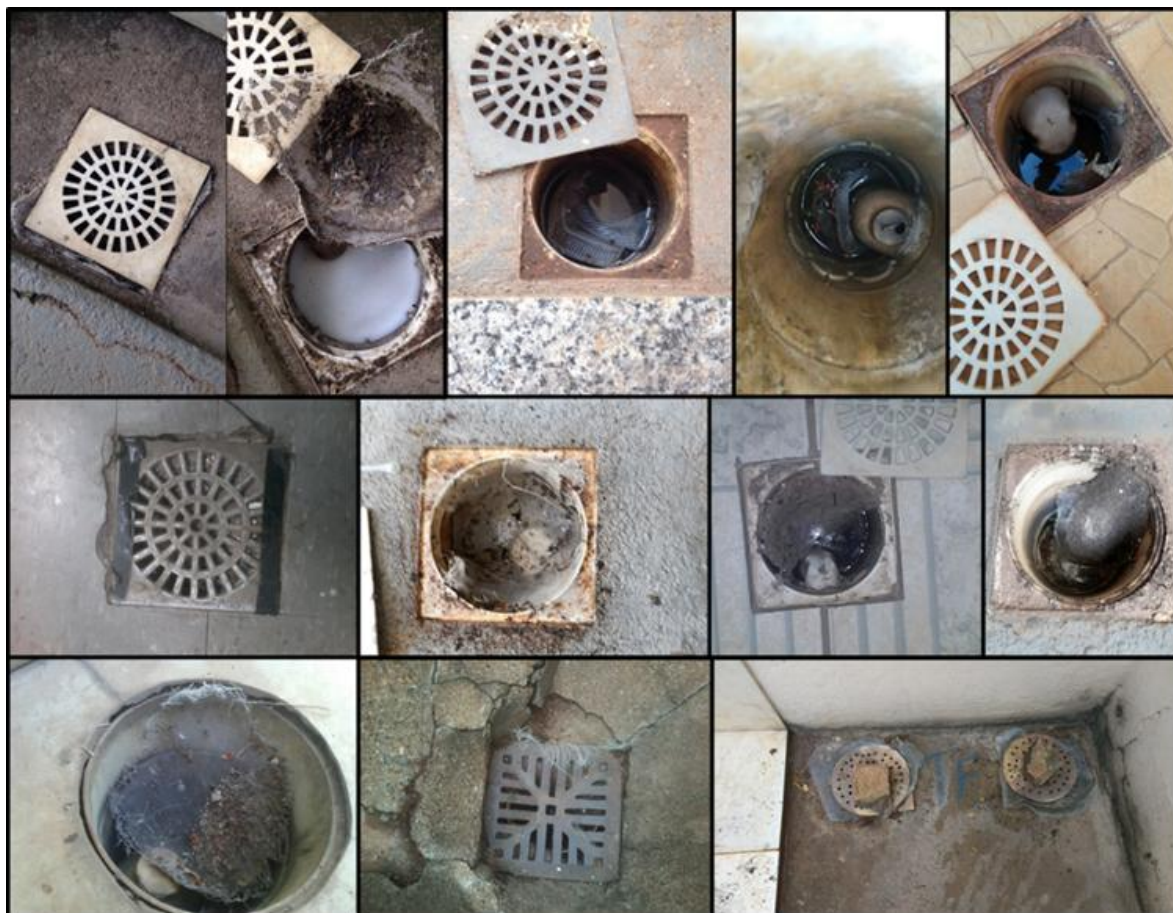
Figura 41. Exemplos de situações ralos domésticos de PVC encontrados com acúmulo de detritos e tela desprendida no fundo dos ralos.
