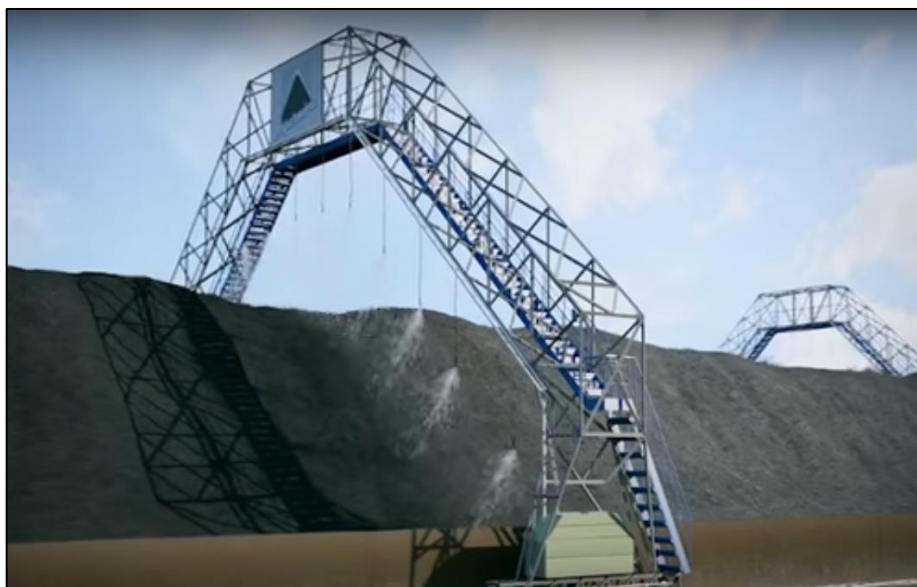
FIGURA 2.2 – Sistema móvel de aspersão para despoeiramento em pilhas de minérios. FONTE – Asperminas (2015) 5
