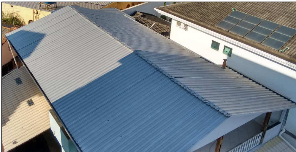
FIGURA 3.6 – Telhado para coleta da água de chuva para avaliação de sua composição. FONTE – Autor
