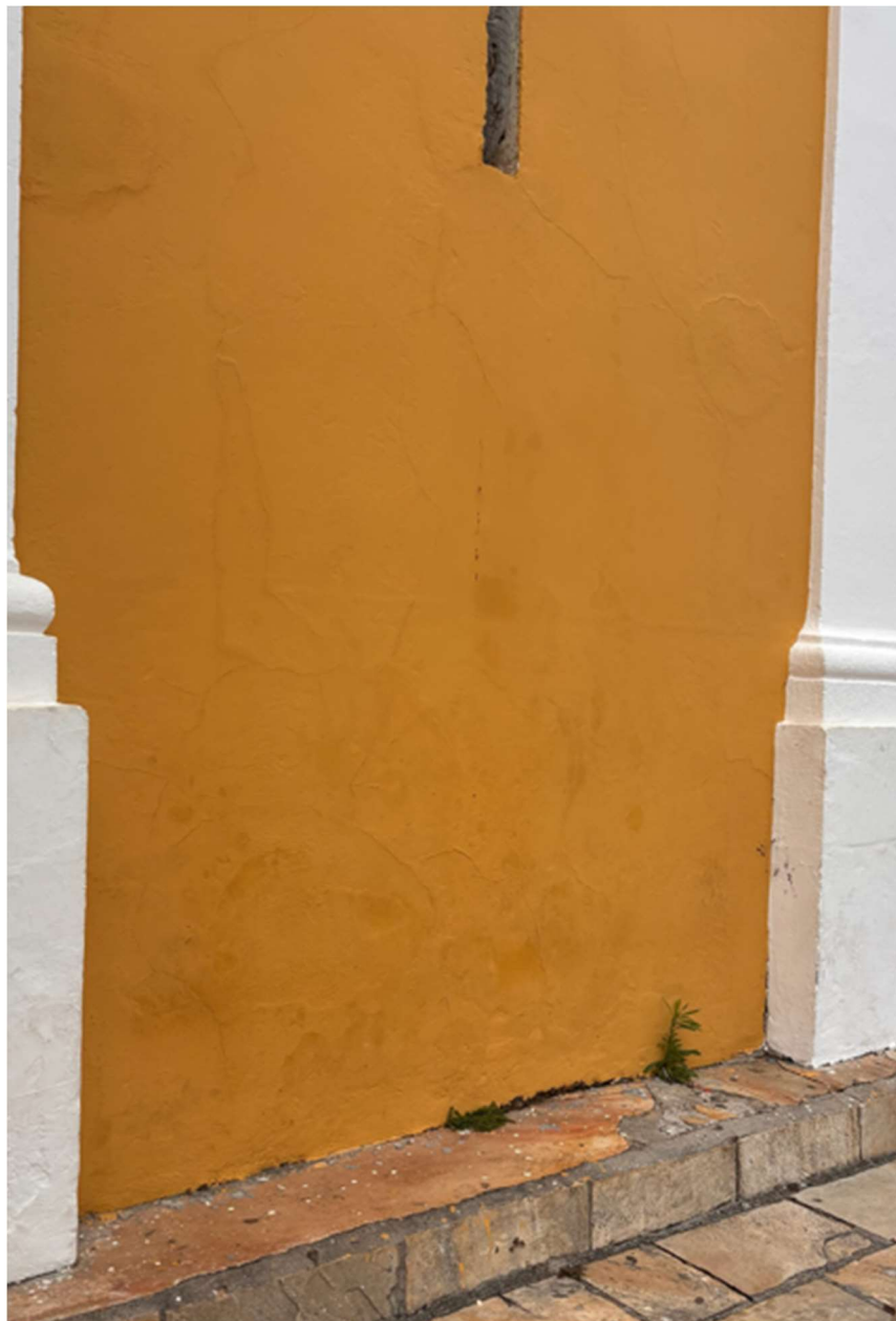
Figura 25 – Sujidade, umidade, irregularidades e vegetação na fachada frontal
