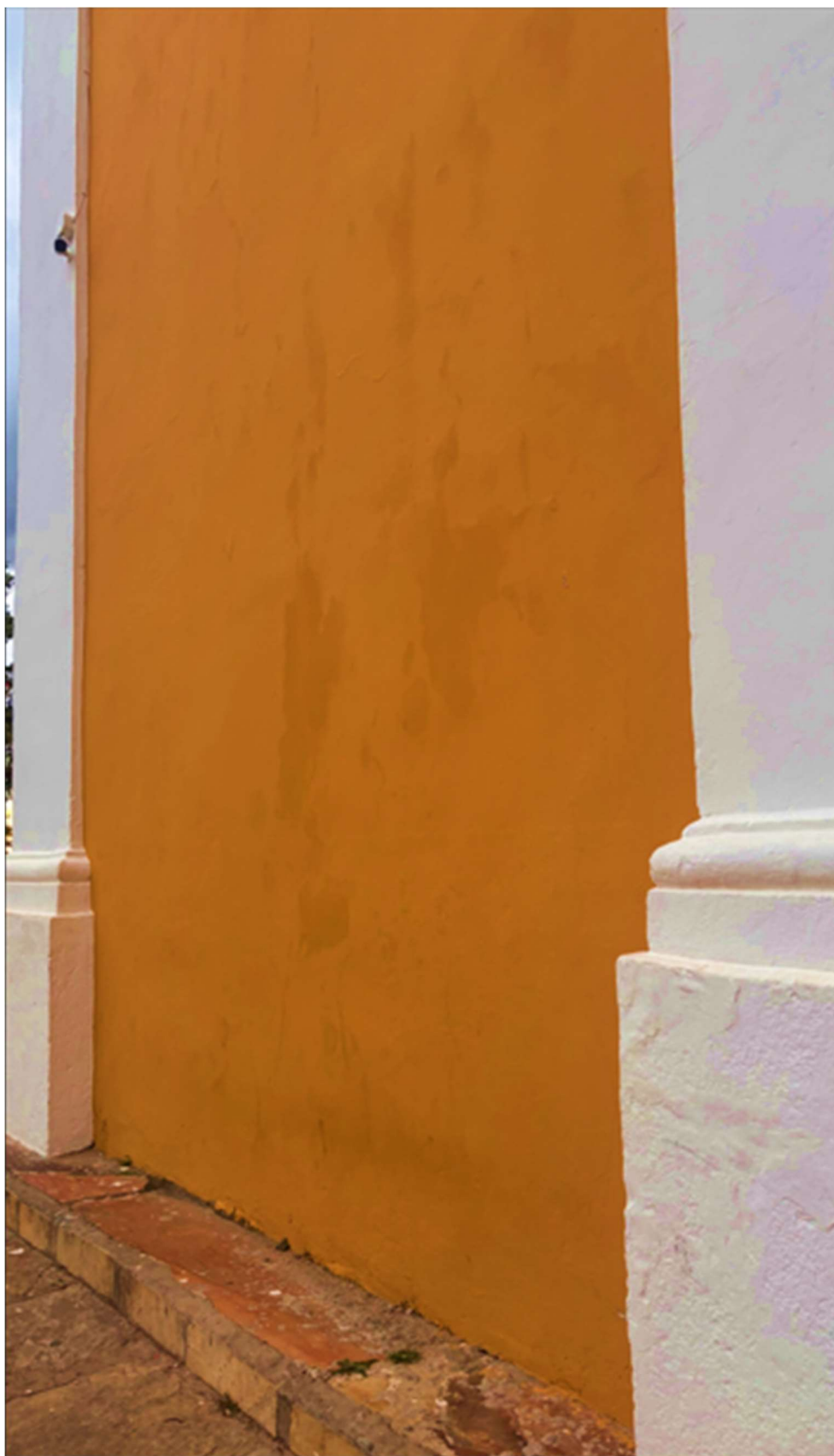
Figura 28 – Manchas de umidade e irregularidades na fachada lateral esquerda
