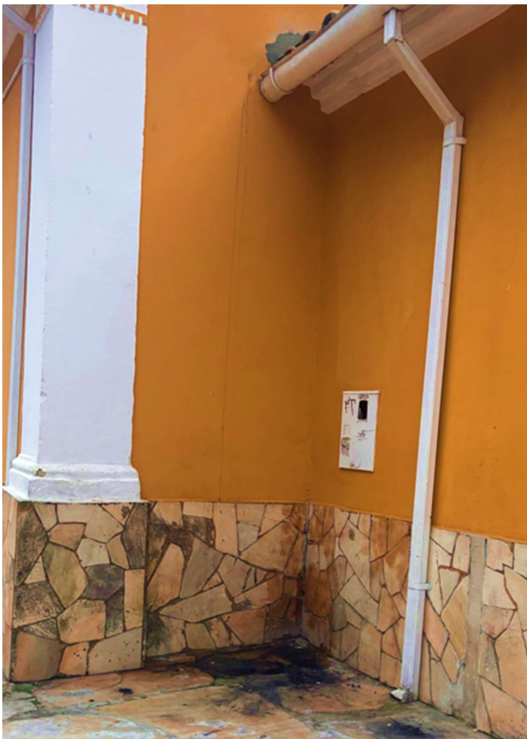
Figura 27 – Mancha de sujidade na fachada lateral esquerda
