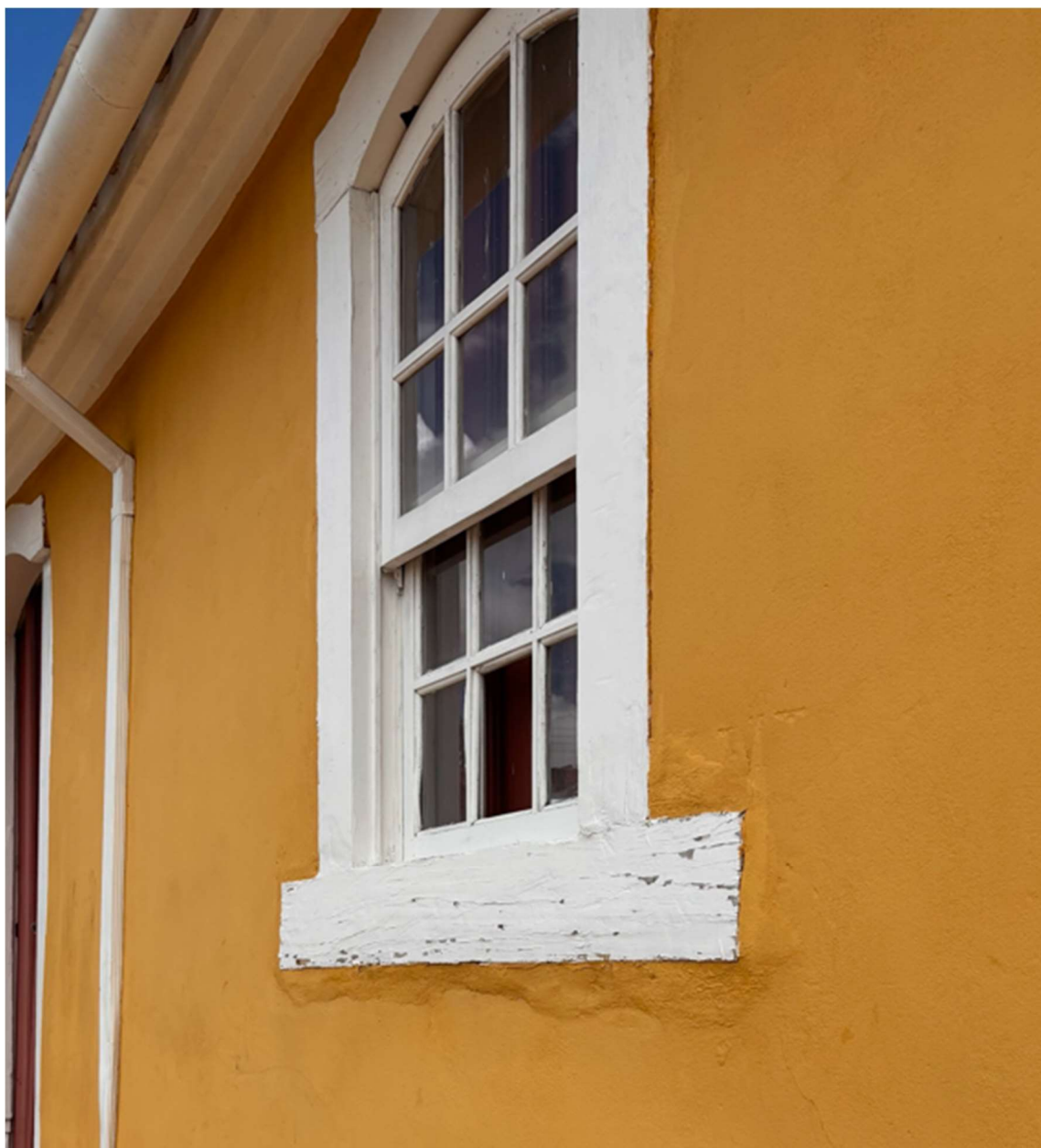
Figura 26 – Vidro quebrado e descascamento da pintura na fachada lateral
