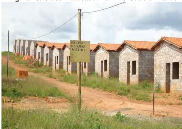
Figura 16: Casas inacabadas na ZEIS Castelo Branco
